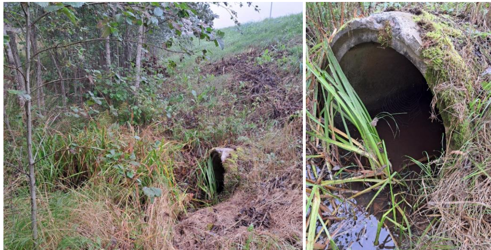
Kuva 10. Maantierumpu, jonka kautta alueelle kulkeutuu pintavesiä alueen eteläpuolelta. Kuva © Destia Oy 9/2024.
