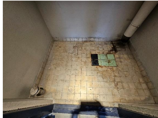
Kuva 83. Tuuletusviemäri on korvattu alipaineventtiilillä, tila ilman lattiakaivoa ja tuuletusviemäri kondensoinut kosteutta.
