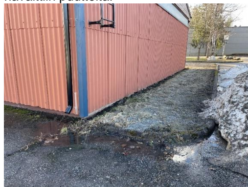
Kuva 4. Sadevedet lammikoituvat kylmän varistorakennuksen vierustalle.
