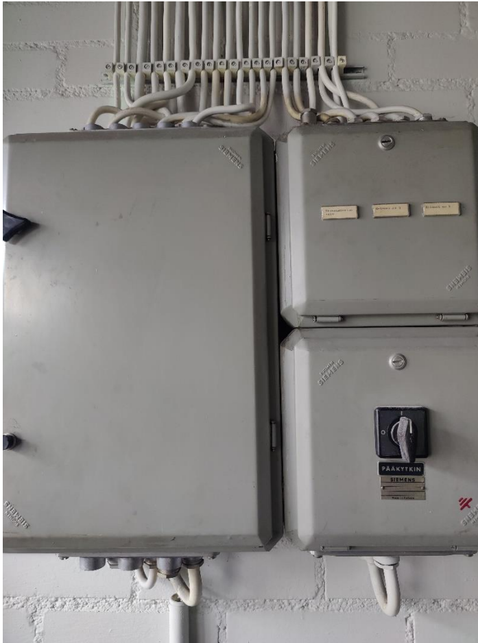
Kuva 117. LVI-laitteiden keskus, nimellisvirta 25A.
