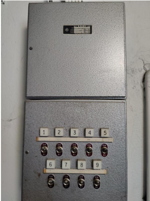
Kuva 119. Lämmönjakohuoneen vanha ESMI keskus.
