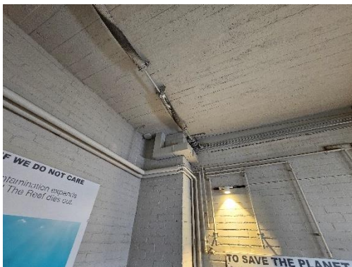
Kuva 78. Seinillä on paljon käytöstä poistettuja vesi- ja lämpöjohtoja. Osassa sulkuventtiilit, osa sulikutulppauksin.
