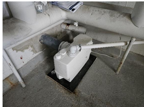
Kuva 87. LJH:ssa sijaitseva pienjätevesipumppaamo harmaille jätevesille.
