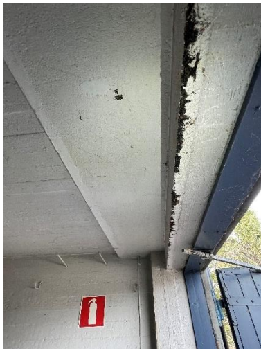
Kuva 43. Ulko-oven yläpuolisessa palkissa havaittiin korkki-eristettä.
