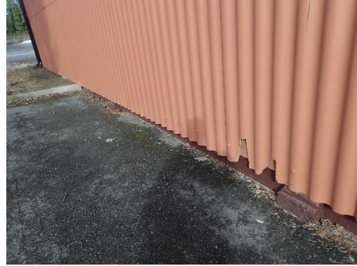
Kuva 26. Julkisivun alaosassa vaurioita.
