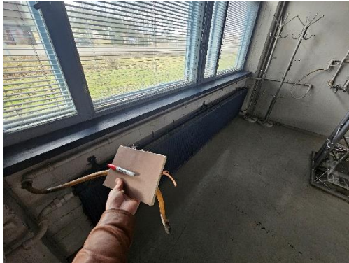
Kuva 80. Vesikalusteita ilman viemärointejä.
