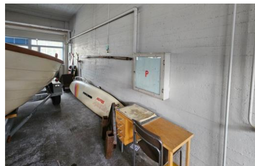
Kuva 110. Pikapalopostikaappi on puutteellisesti merkitty eikä sen sijainti ilmene eteen varastoitujen suurien tavaroiden takia muualta tilasta.
