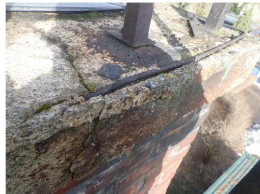
Kuva 32. Lämmityshormin betoninen reunus on rapautunut.
