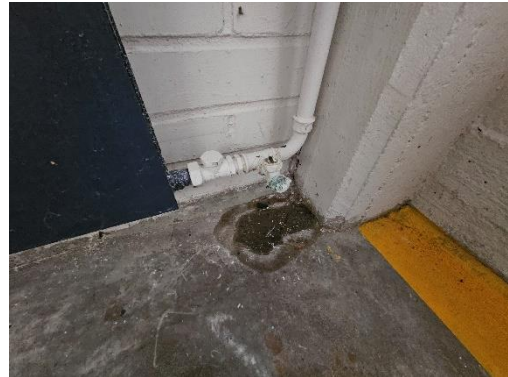
Kuva 69. Vuotava iäkäs patteriventtiili.
