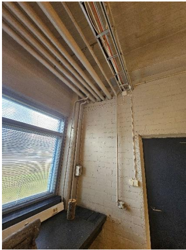
Kuva 68. Lämpöjohdot ovat terästä. Lämmönjakohuoneen ja runkolinjojen lämpöjohtojen eristeet on uusittu PVC-muovipinnoitetuiksi mineraalivillaristeiksi.
