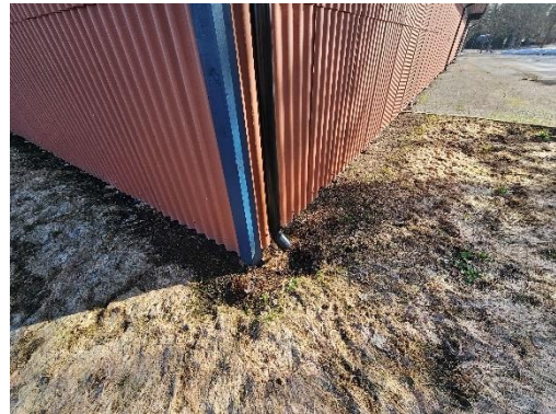
Kuva 91. Syöksytörvien jälkeinen sadevedenohjaus ei toimi, vaan vesi jää rakennuksen sivustalle.
