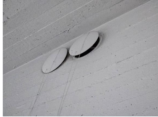
Kuva 102. Lautasventtiilit ovat osittain suljettu, eikä vedettävä liukuventtiili toimi.
