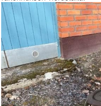
Kuva 3. Ulko-oven betoniaskelmassa havaittiin rapautumaa.
