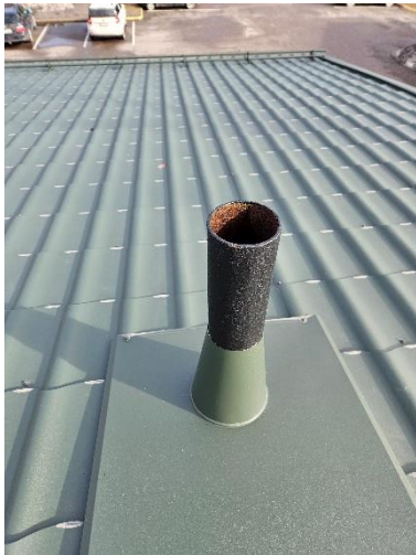
Kuva 84. Tuuletusviemäristä puuttuu sadehattu.
