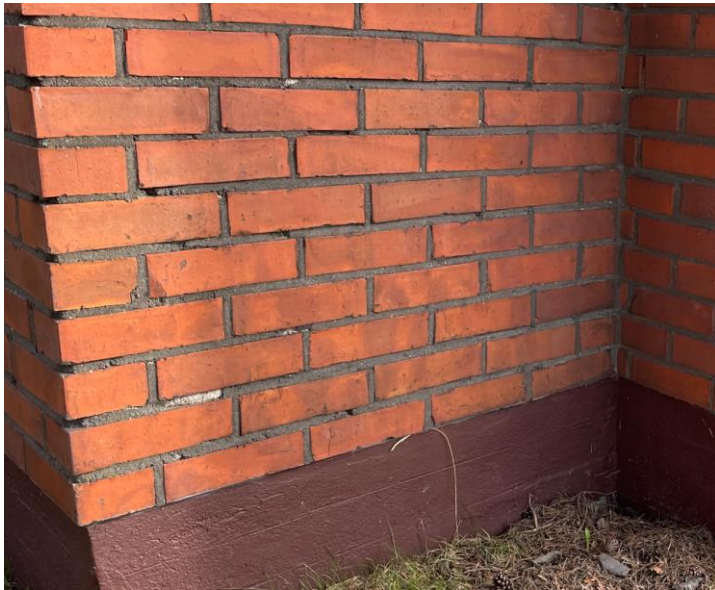
Kuva 33. Päätymuurauksen saumat ovat kuluneet.
