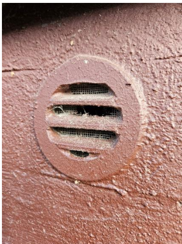
Kuva 107. Korvausilmaventtiilien määrä ovat hyvin rajallinen ja osassa pieneläinverkot ovat rikkoutuneet.
