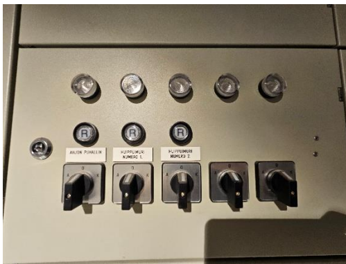
Kuva 95. Ryhmäkeskuksen huippumureiden nokkakytkimet. Asennossa 0 (ei käytössä).
