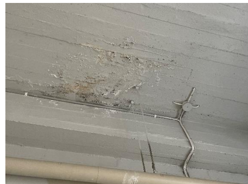
Kuva 18. Yläpohjalaatassa havaittiin yksittäinen kosteusjälki.
