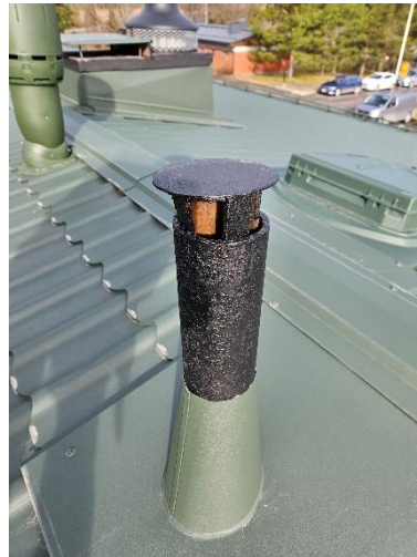
Kuva 85. Tuuletusviemäristä puuttuu kunnollinen sadehattu.
