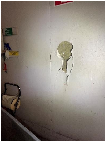
Kuva 60. Kylmän varaston kipsilevyrakenteisessa väliseinässä vaurio.
