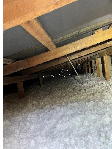
Kuva 47. Kattokannattajat ovat hyväkuntoisia.
