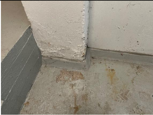
Kuva 20. Lämmönjakokeskuksessa pilarin alaosassa kohonnuttu kosteutta.
