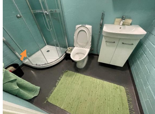
Kuva 89. WC-tilaan on asennettu suihkukaappi. Tilassa ei näkyvää lattiakaivoa.
