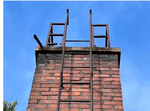
Kuva 30. Lämmityshormin kaiteet ovat ruostuneet.
