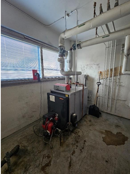
Kuva 61. Kiinteistön öljypoltin on laitekilpien mukaan vuodelta 2018.
