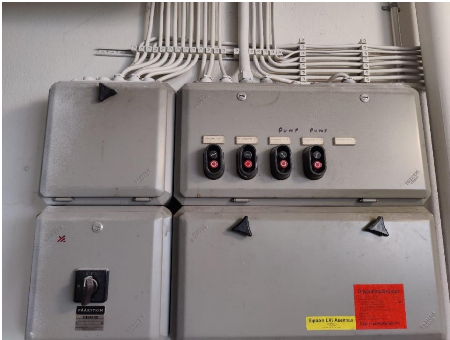
Kuva 118. Lämmönjakohuoneen keskus. Nimellisvirta 25A.
