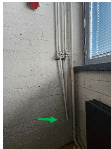
Kuva 79. Käytöstä poistetuista vesijohdoista puuttuu sulikutulppaukset, ovat sulkuventtiilien varassa.
