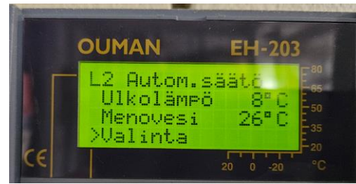
Kuva 66. Lämmitysverkon menoveden lämpötilat 26 °C kiinteistöierroksen aikana. Ukolämpötila oli tarkastushetkellä +8 °C.
