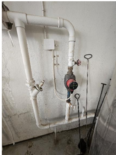
Kuva 67. Lämmityksen ensiöpuolen vuonna 2018 uusittu kiertovesipumppu varaajan ja öljykattilan välillä
