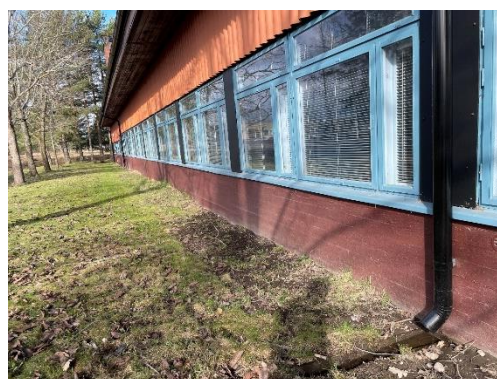
Kuva 2. Pintavesien poisjohtamisessa havaittiin puutteita.
