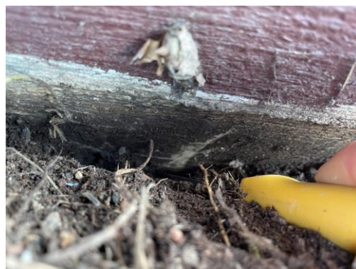
Kuva 7. Sokkelissa ei havaittu vedeneristettä tai patolevyä.
