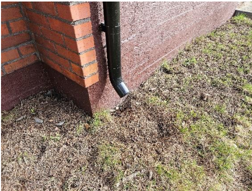
Kuva 90. Syöksytörvien jälkeinen sadevedenohjaus ei toimi, vaan vesi jää rakennuksen sivustalle.
