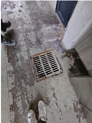
Kuva 82. Hallitiloissa ritiläkannelliset kaivot.
