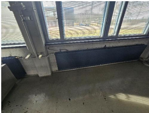
Kuva 70. Hallitilojen lämmönluovuttimet ovat suurelta osin uusittuja
