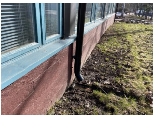
Kuva 1. Sadevedet eivät poistu rakennuksen vierustalta.
