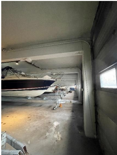
Kuva 54. Autohallin lattian maalipinnoitteet ovat paikoin kuluneet.
