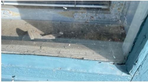
Kuva 37. Heloituksissa paikoin Ruostetta.
