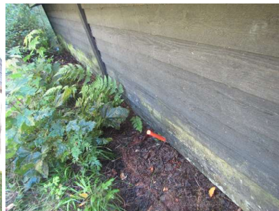
Kuva 17: Alimmat ulkoverhouslaudat ovat lahonneet.
