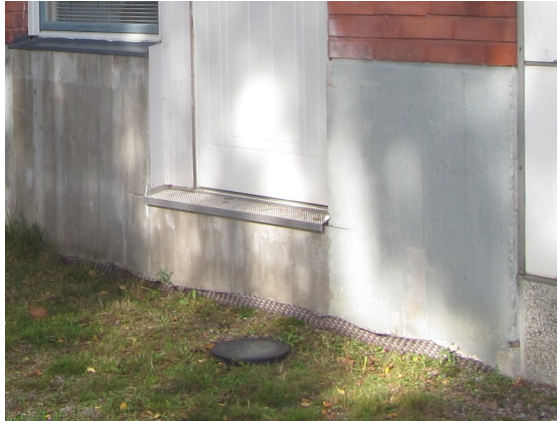
Kuva 7: Perusmuurilevyn yläosasta puuttuu lista.
