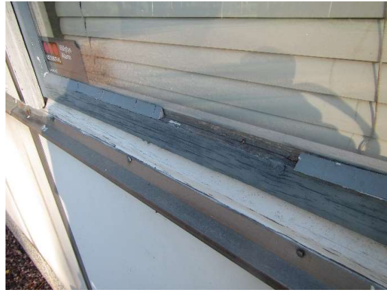
Kuva 19: Lasituskitti irttoilee paikoin.
