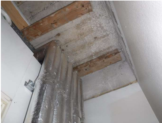
Kuva 45: Käyttövesiputket on eristetty asianmukaisesti.
