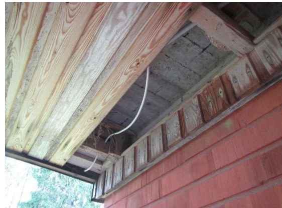
Kuva 15: Osa paneloinnista puuttuu.
