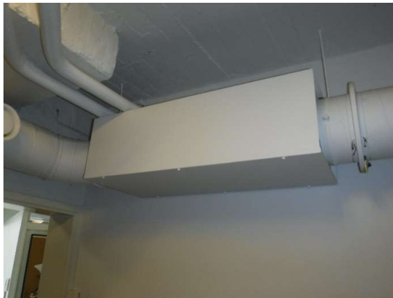
Kuva 58: Kanavaäänenvaimentimien eristemateriaali on suositeltavaa tarkastaa ja tarvittaessa vaihtaa.
