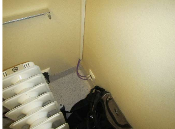
Kuva 89: Näkymää ATK:n RJ45-rasiosta
