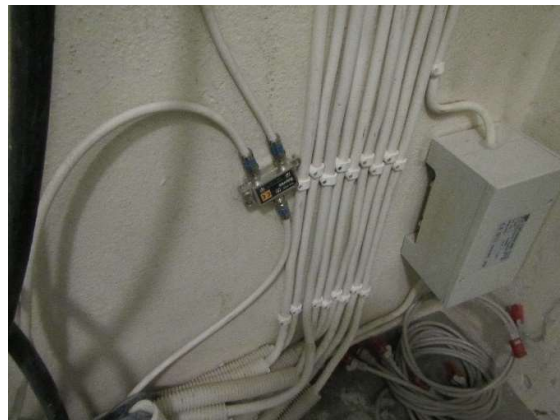
Kuva 85: Näkymää pohjakerroksen antennihaarottimesta
