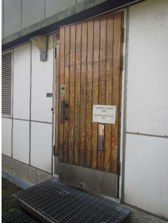
Kuva 22: Alkuperäisen ulko-oven lakkapinta on kulunut.
