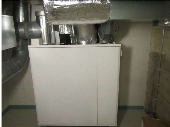
Kuva 80: Näkymää pohjakerroksen IV-koneesta
