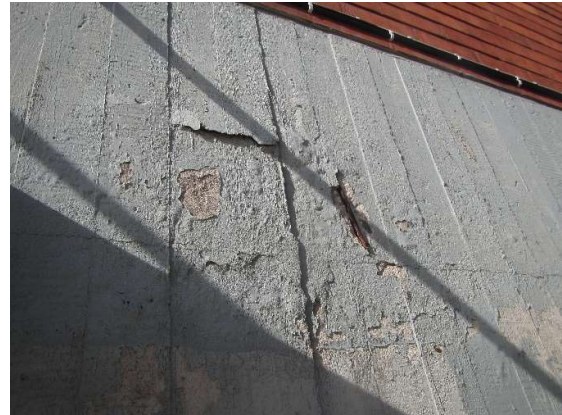
Kuva 13: Betonisokkelin maalipinta irtoilee ja sokkelissa on lohkeamia.
