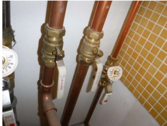
Kuva 46: Linjasäätö ja sulkuventtiilit on uusittu 2000-luvulla.
