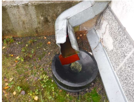
Kuva 53: Syöksytorvien alaosissa on korjaustarvetta.
