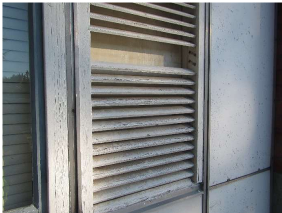
Kuva 20: Tuuletusluukkujen kohdalla on säleikkö, josta puuttuu paikoin rimoja.
