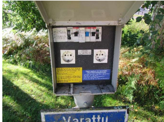
Kuva 66: Näkymää autolämmityskotelon pylväästä
