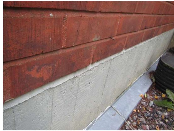
Kuva 9: Tiilijulkisivun alaosissa ei ole tuuletusaukkoja.
