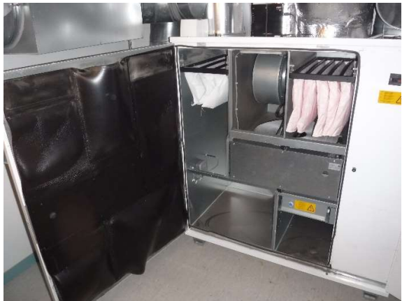
Kuva 55: Yleisilmanvaihtokone Enervent Pegasos on uutta vastaavassa kunnossa.
