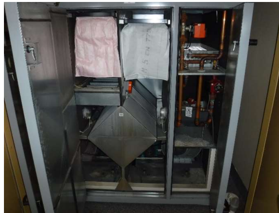
Kuva 56: Yleisilmanvaihtokoneella Kair Power 3000 on vielä käyttöikää jäljellä.
