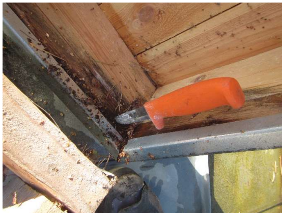
Kuva 29: Käyntiluukun kannessa on lahovaurioita.
