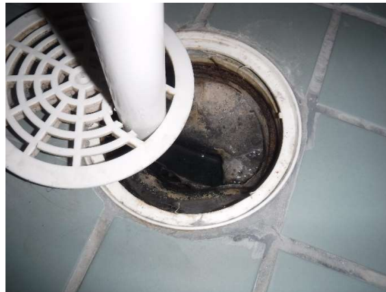
Kuva 49: Vesilukot ja lattiakaivot on valmistettu muoviosista.
