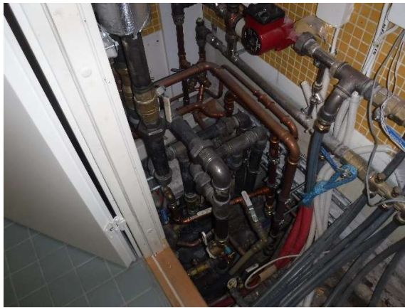
Kuva 40: Yleiskuva Pleissin terveysasemalta tulevista lämmitys- ja käyttövesisyötöistä.
