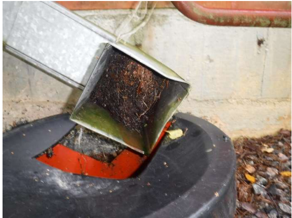
Kuva 52: Kattosadevesijärjestelmän syöksytorvissa on puhdistustarvetta.
