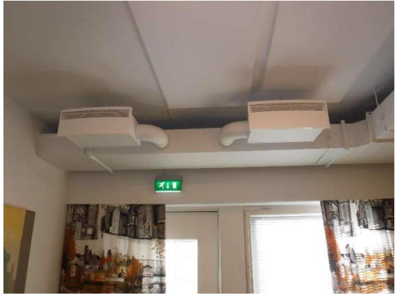
Kuva 60: Tuloilman päätelaitteet ovat erityyppisiä säleiköitä ja hajottajia.
