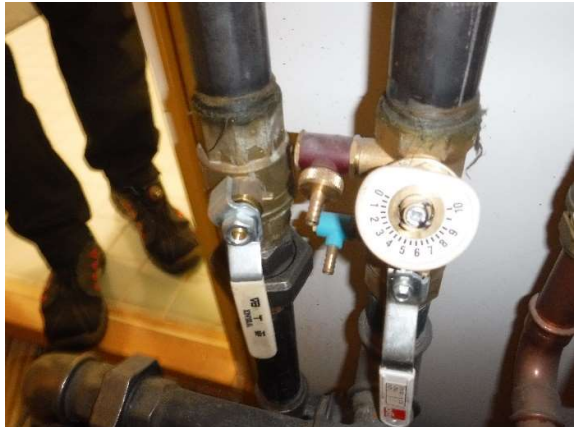
Kuva 41: Lämmitysverkoston linjasäätö- ja sulkuventtiilit ovat pääosin uusittuja malleja.
