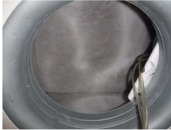
Kuva 61: Tuloilman päätelaitteiden paineentasauslaatikoissa on tarkastetuilta osin kuituja päästämätön ääneneristys.
