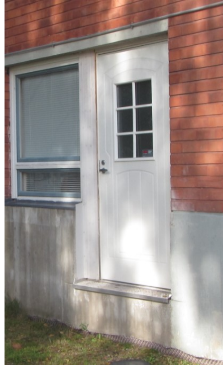
Kuva 23: Alapihan puoleinen ulko-ovi on uusi ja oviaukko on puhkaistu mahdollisesti jälkepäin.
