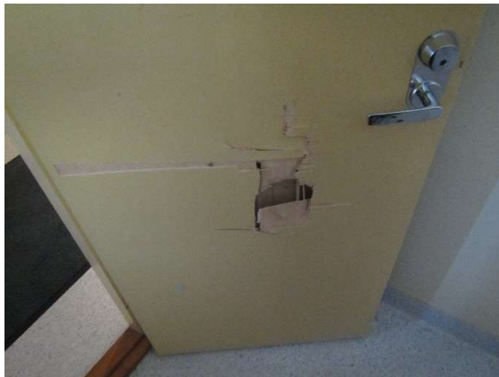
Kuva 31: Yhdessä väliovessa on suuri kolhu.
