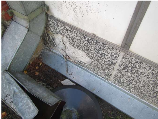
Kuva 12: Yksittäinen sokkeli levy on vaurioitunut.
