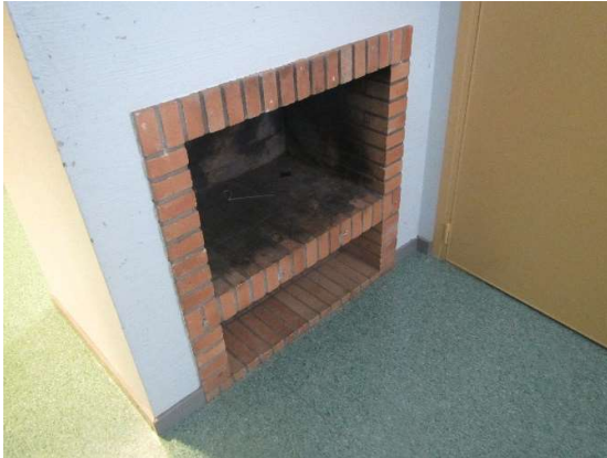
Kuva 1: Takan edustalla ei ole peltiä lattiassa.
