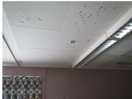
Kuva 35: Biljardisalin akustovillalevyt ovat repaleiset.
