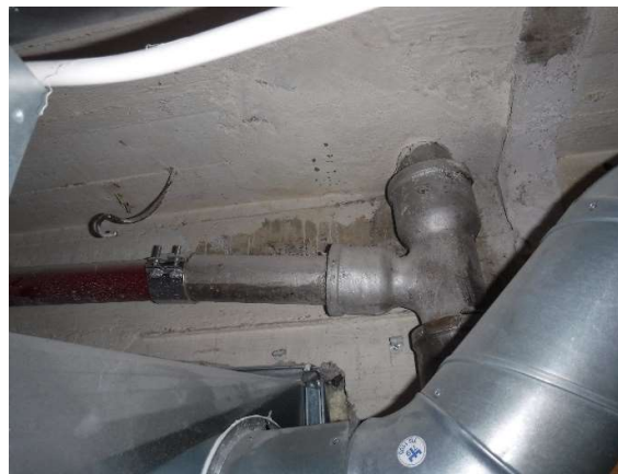
Kuva 51: Uudempaa pantaliitoksellista valurautaviemäriä liitettynä alkuperäiseen lyijyjuotosviemäriin.
