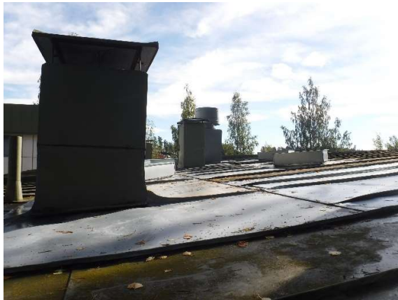
Kuva 57: Vesikatolle sijoitetut huippuimurit palvelevat wc-tiloja.
