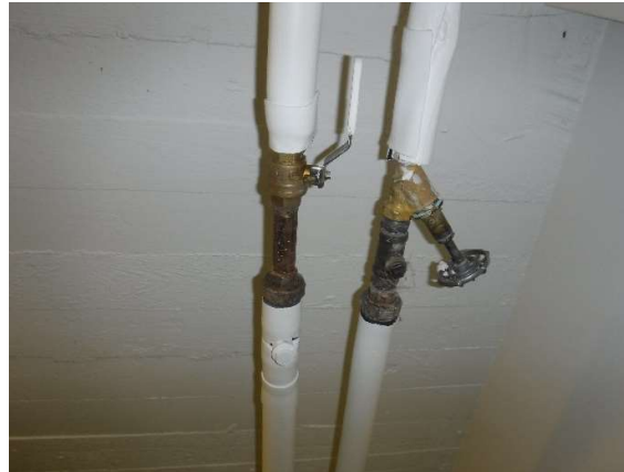
Kuva 42: Lämmitysverkoston vanhoja venttiileitä.
