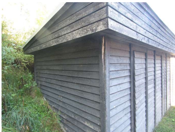
Kuva 16: Ulkoveraston ulkoverhouksen puunsuoja-aine on monin paikoin kulunut pois.
