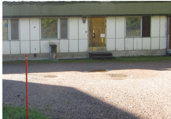
Kuva 3: Yläpihan sorakentälle lammikoituu vettä.
