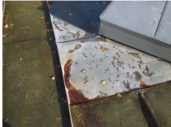
Kuva 26: Uusi peltikate on maalaamaton ja siinä on ruostetta paikoin.
