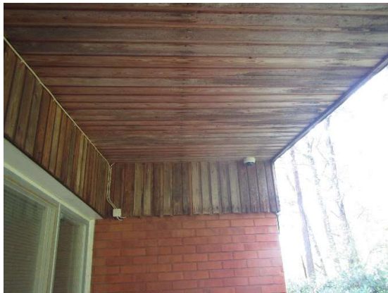
Kuva 14: Katoksen yläosan paneloinnissa on homepilkkuja.
