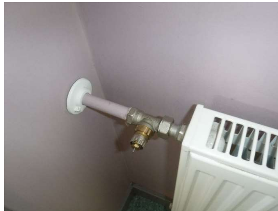
Kuva 44: Lämmityspatterin venttiilistä puuttuu termostaattiosa.
