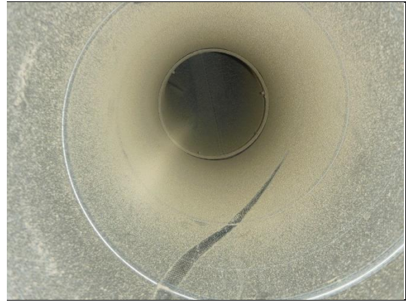
Kuva 37. Yläkerran poistoilmakanavan pyyhkäisyjälki
