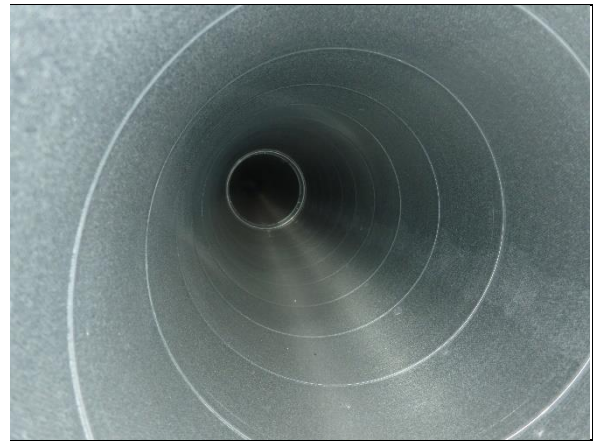
Kuva 39. Yläkerran tuloilmakanavan pyyhkäisyjälki
