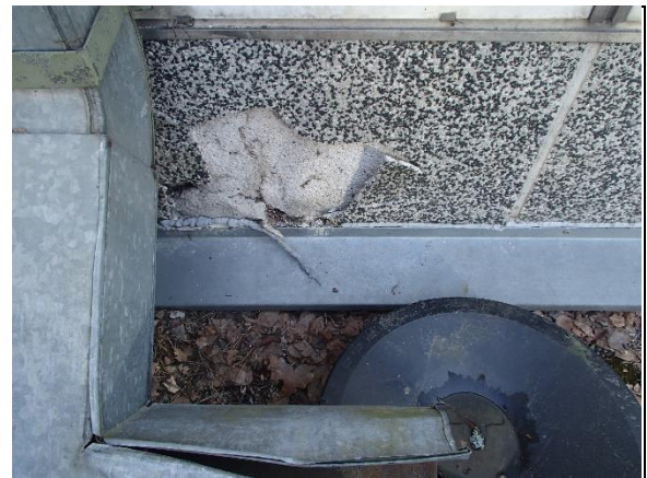
Kuva 21. Kosteusvaurio sokkelissa yläpihan puolella syöksytorven vieressä.
