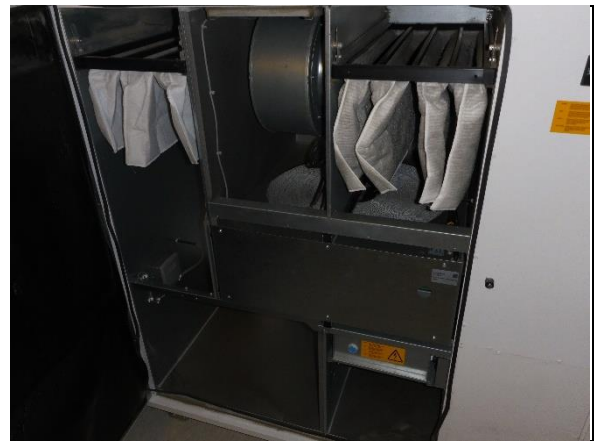
Kuva 27. Alakerran ilmanvaihtokone sisältä
