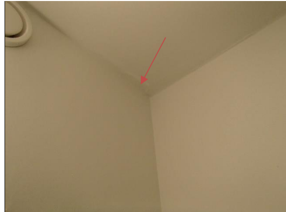
Kuva 9. Maali kupruilee WC:n katossa.
