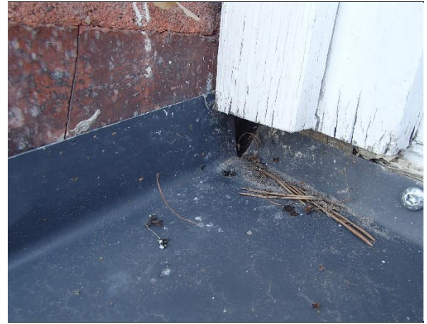
Kuva 19. Rako ikkunanpellin nurkassa.
