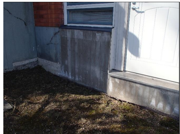
Kuva 17. Jälkiä kosteusrasituksesta sokkelissa harrastetilan kohdalla. Patolevy ei ole kiinni sokkelissa.
