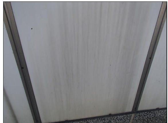
Kuva 23. Valumajälkiä ulkoseinän mineriittilevyssä.
