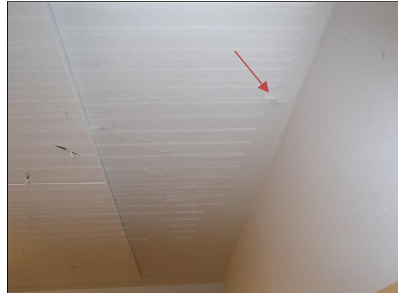
Kuva 13. Oleskelutilan A213 katosta irtoilee maali.
