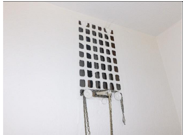
Kuva 35. Painovoimaisen ilmanvaihtojärjestelmän poistoilmasäleikkö
