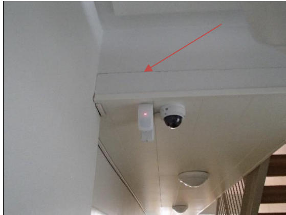
Kuva 8. Halkeama betoniseinässä käytävällä A 107.
