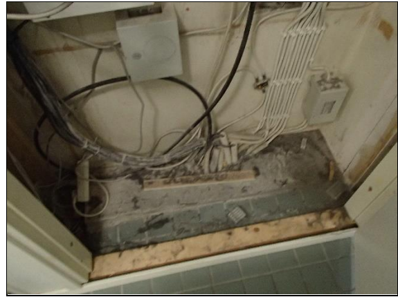
Kuva 7. Käytävällä A107 sijaitseva sähkökaappi on likainen.
