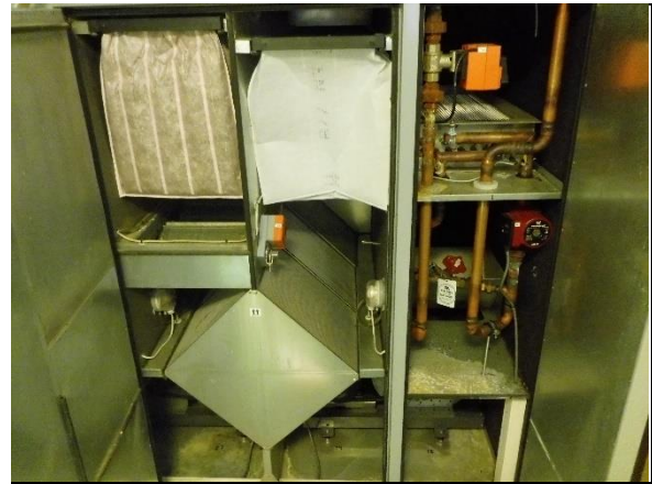
Kuva 29. Yläkerran ilmanvaihtokone sisältä
