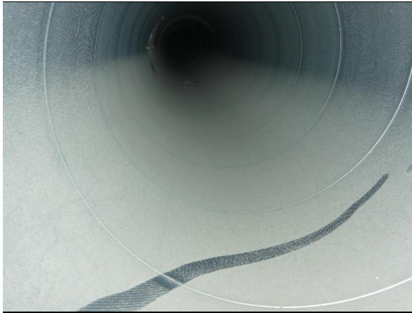
Kuva 36. Alakerran poistoilmakanavan pyyhkäisyjälki
