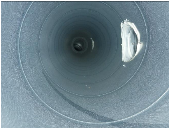
Kuva 38. Alakerran tuloilmakanavan pyyhkäisyjälki
