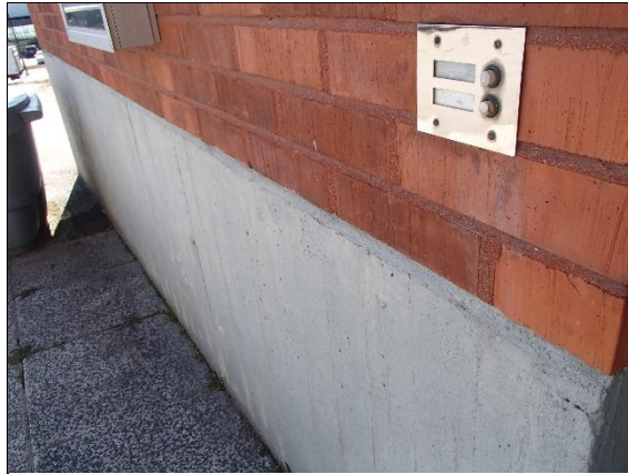
Kuva 24. Tiilien välissä ei ole tuuletusrakoja.
