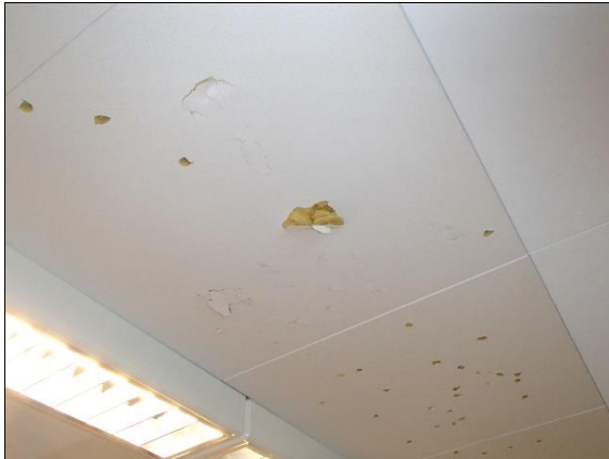
Kuva 12. Oleskelutilan A213 katossa on rikkinäisiä akustiikkalevyjä.
