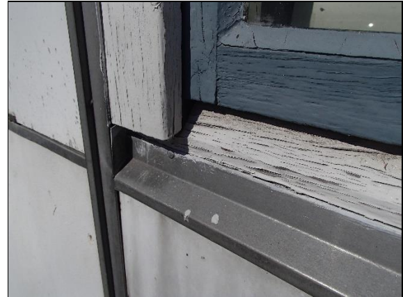
Kuva 25. Ikkunankarmit ovat hapertuneet.
