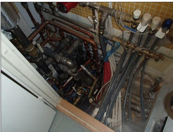
Kuva 10. Teknisen tilan A115 pohjalla kulkee putkikaanaali.
