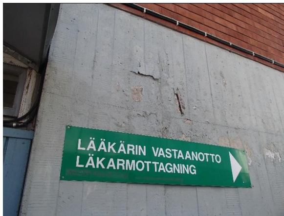
Kuva 16. Jälkiä kosteusrasituksesta sisäänkäynnin vieressä.
