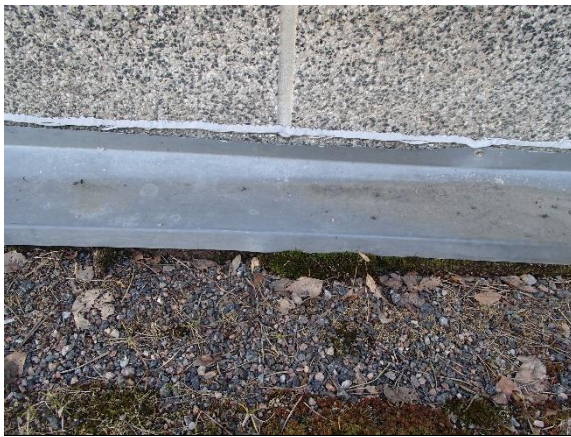
Kuva 20. Yläpihan puolella pelti sokkelin vieressä. Yläpuoli ei ole tiivis.
