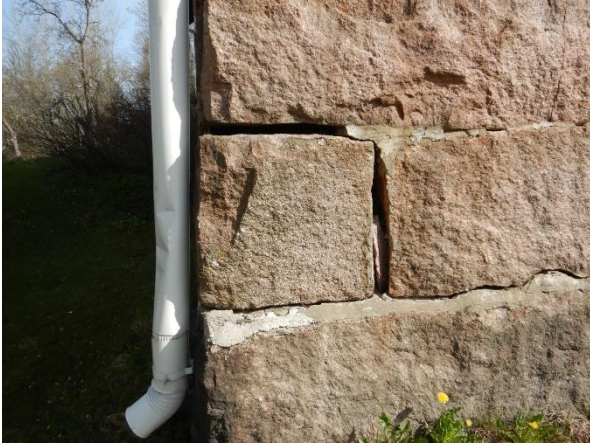
Kuva 3. Luonnonkivien laastisaumoissa havaittiin rapaumaa ja murtumia. Perusmuurissa ei ole varsinaisia tuuletusaukkoja.
