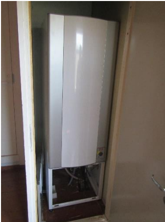
Kuva 38. Lämminvesivaraaja on asennettu yläkerran komeroon, jossa ei ole lattialaivoa.
