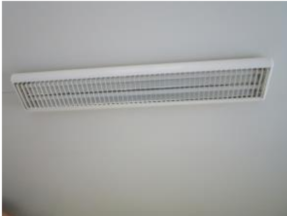
Kuva 64. Valaistus on pääosin toteutettu loisteputkivalaisimia käyttäen
