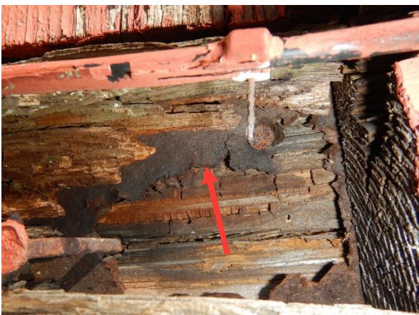
Kuva 17. Julkisivulaudoituksen alla oleva tervapahvi on vaurioitunut
