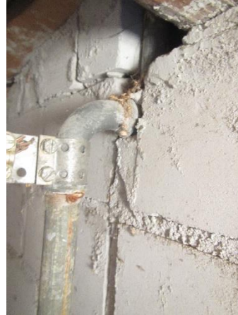
Kuva 37. Vesimittarilta lähtevä kylmän veden runkojohto on kuumasinkittyä teräsputkea.
