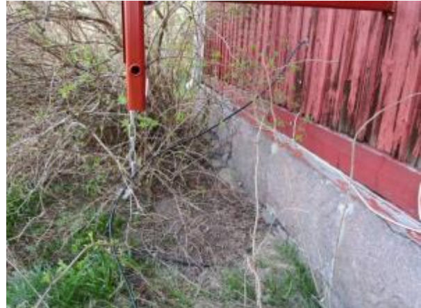
Kuva 77. Kuitukaapeli on kiepillä maassa osin ruohon peitossa ja kulkee sisälle kiinnittämättä ja suojaamatta
