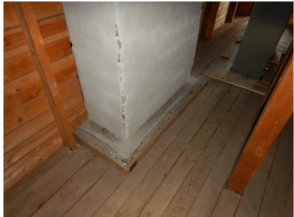
Kuva 27. Piipun vierustalla koteloitu hiekkapeti.
