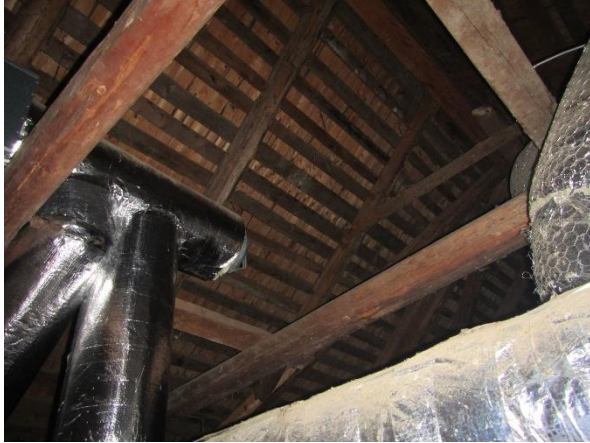
Kuva 46. Eristetyt raitisilmakanavat ullakotilassa.
