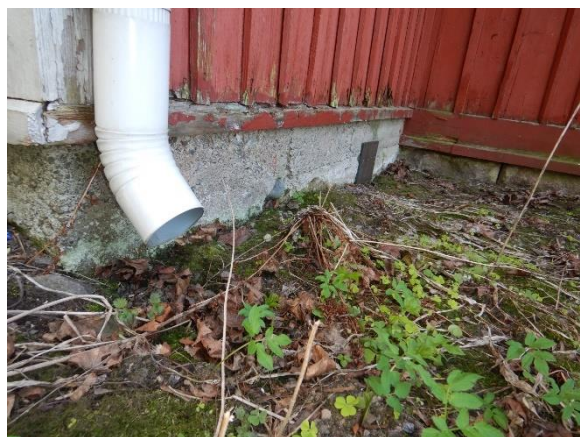
Kuva 29. Vesikatolta valuvat sadevedet ohjautuvat talon vierustoille maahan.
