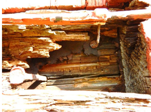
Kuva 10: Ulkoseinien alimmissa hirsissä havaittiin lahovaurioita. Kuvassa näkyy myös tervapahvia hirren ulkopinnassa lahonneen verhouksen takana.
