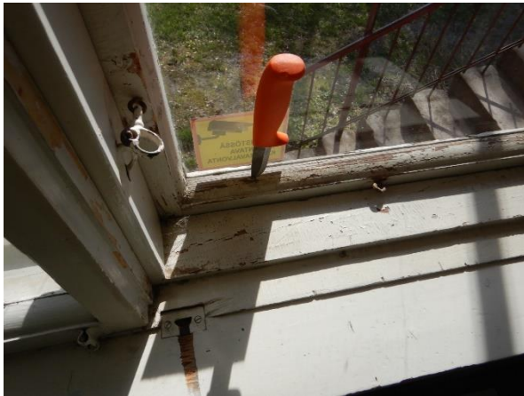
Kuva 18. Ikkunoissa ei havaittu tiivisteitä. Ikkunoista ei havaittu merkittäviä lahovaurioita.
