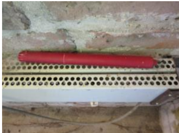
Kuva 71. Kynttilä kellarin patterin päällä tulee poistaa ennen kuin patteria aletaan lämmittämään
