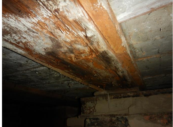
Kuva 4. Tuulettuvan alapohjan tarkastuksessa havaittiin mahdollisia kosteusvaurioita alapohjan puupalkissa.
