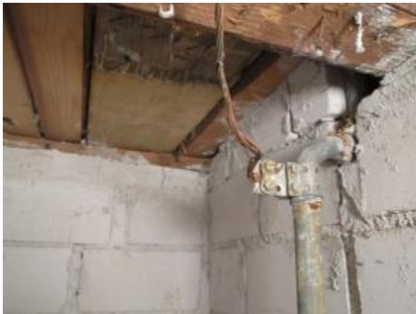
Kuva 56. Putkiston maadoitus kellarissa
