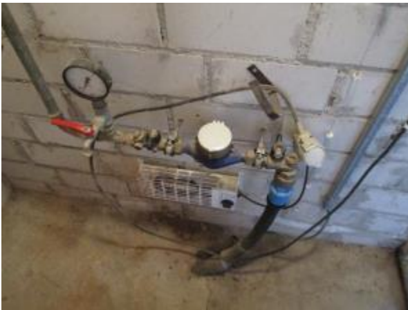
Kuva 70. Pakkasvahti ja vesijohdon saattolämmitys
