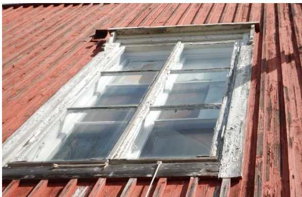
Kuva 20. Ikkunoiden puuosissa havaittiin runsaasti maalipinnan irtoamista ja lasituskittausten lohkeilua. Osa ikkunaruujuista oli halki.
