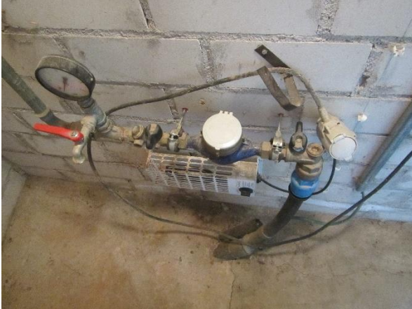
Kuva 36. Kiinteistön päävesimittari on kellarin teknisessä tilassa.
