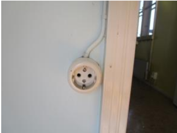
Kuva 60. Vanha nollattu ja suojalaitteeton pistorasia
