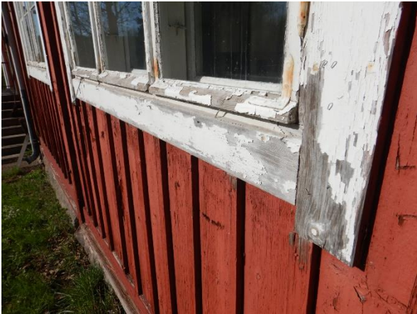
Kuva 15. Ikkunoiden piililaudoitusten maalipinnoite irtoilee.
