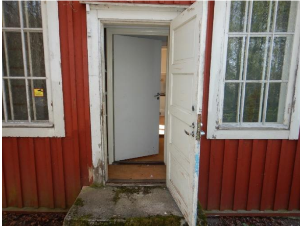
Kuva 22. Asunnon ulko-oven pintakäsittelyssä havaittiin malipinnan kulumista ja irtoamista.
