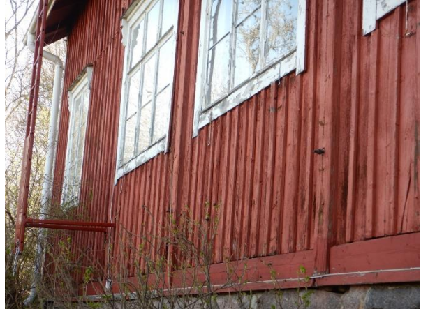
Kuva 14. Lautaverhouksessa havaittiin lahovaurioita.
