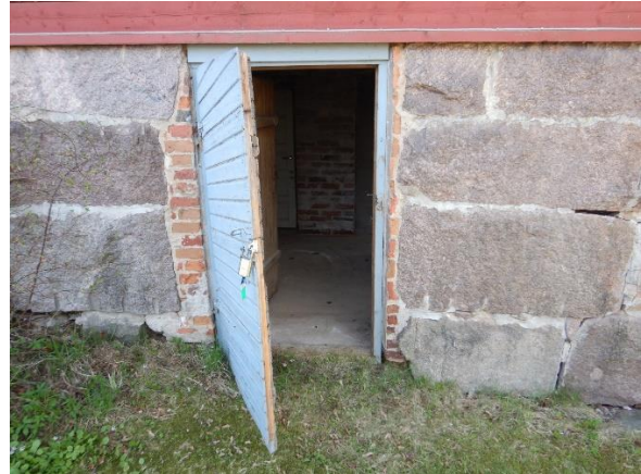
Kuva 23. Kellaritilojen ulko-ovi on epätiivis vanha puuovi.
