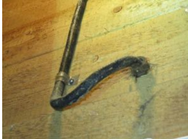
Kuva 59. Osa käytössä olevista kaapeleista on todella vanhoja, kangaspäällysteisiä ja kumi/muovieristeisiä haurastuneita kaapeleita
