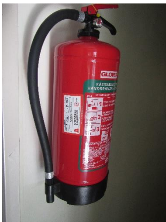
Kuva 48. Yleiskuva jauhesammuttimesta alakerrassa.
