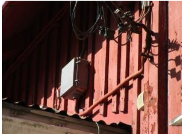
Kuva 55. Pääsulakekotelo rakennuksen seinällä
