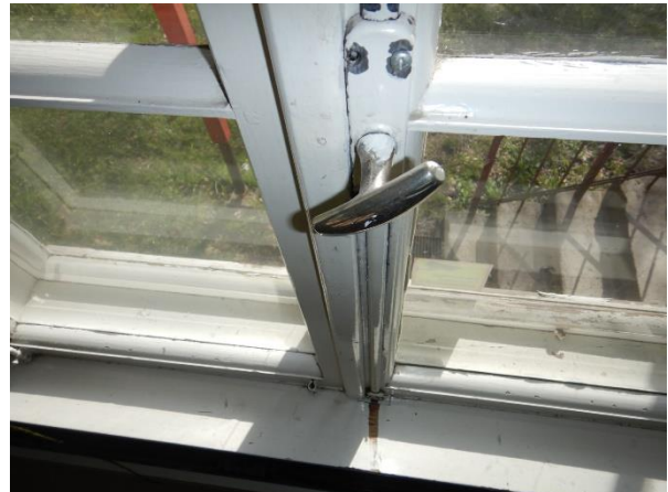
Kuva 19. Ikkunoiden kiinnipitimet ovat vanhoja, mutta pääosin toimivia.
