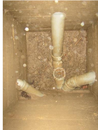
Kuva 43. Muoviviemäreitä kellarikerroksen tarkastuskaivossa
