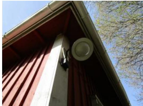
Kuva 51. Asunnon puoleisen päädyn seinävalaisin
