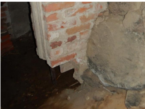
Kuva 7. Tiilimurauksen alaosa on purettu tai murtunut.
