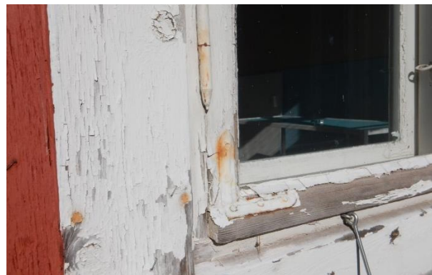
Kuva 21. Maalipinnoitteen irtoamista ja lasituskittausten lohkeilua ja irtoamista. Teräsosissa hieman korroosiota.
