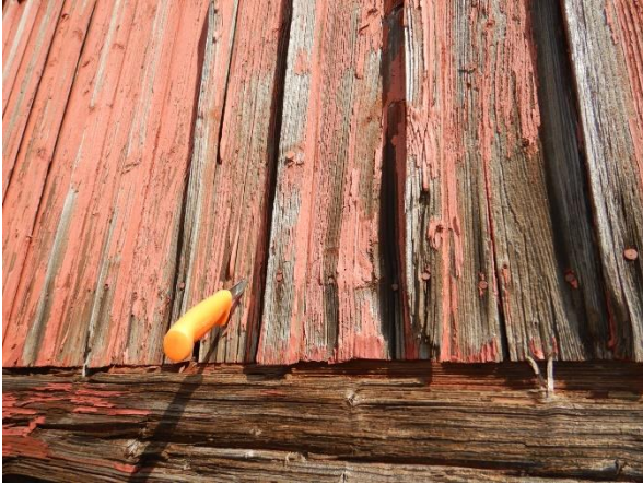
Kuva 13. Lautaverhouksen alaosien lahovaurioita ja maalipinnoitteen irtoilua.
