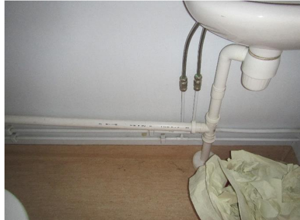
Kuva 39. Pinta-asenteisia vesijohtoja wc-tilassa.
