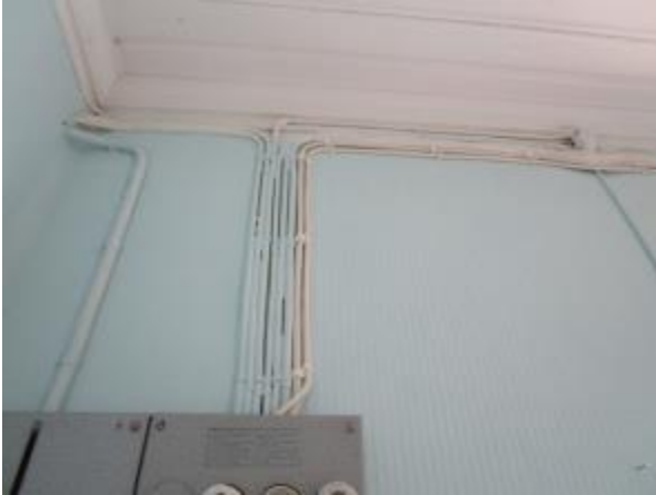
Kuva 58. Ryhmäkeskukselta lähtevät ryhmäjohdot pinta-asennettuina
