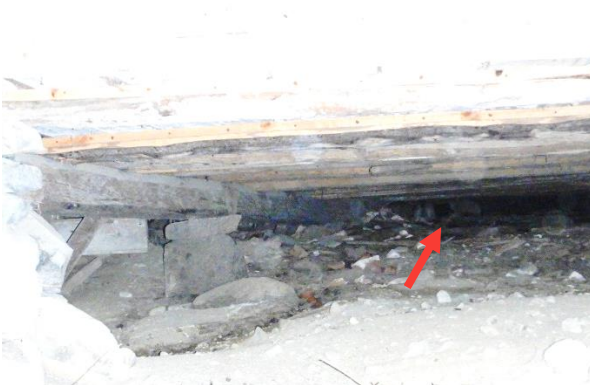
Kuva 5. Alapohjan pääkannattaja on arviolta maakosketuksessa pohjoispäädysssä.
