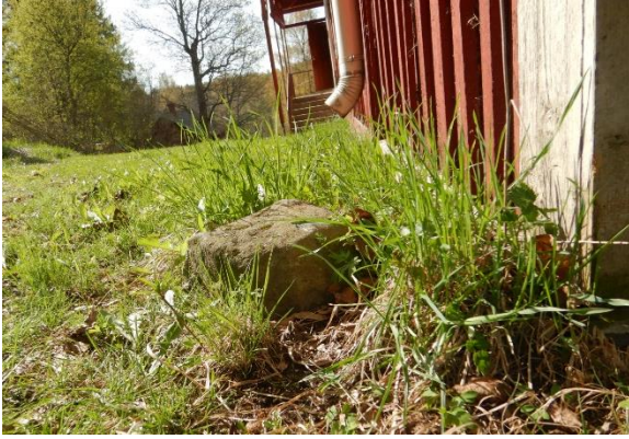
Kuva 1: Koilliskulmalla maanpinta on puurakenteisen ulkoseinän tasolla ja maanpinnan kallistus on loivaa.
