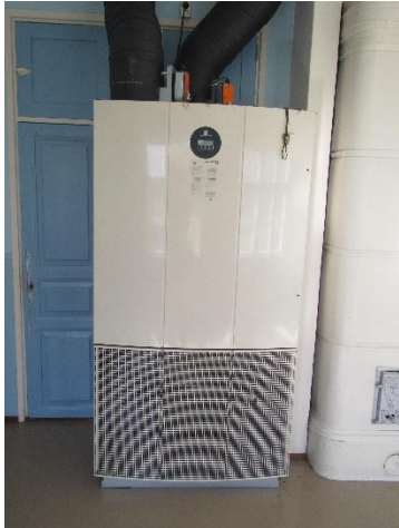
Kuva 44. Yleiskuva luokkatilaa palvelevasta ilmanvaihtokoneesta.
