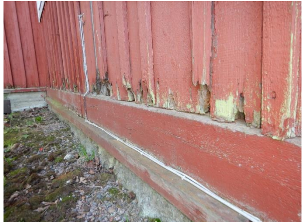
Kuva 16. Lautaverhouksessa havaittiin runsaasti vaurioita alaosissa
