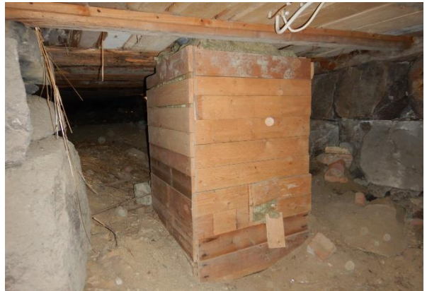
Kuva 6. Puinen mineraalivillalla eristetty kotelo, jossa havaittiin viemäröintiä.
