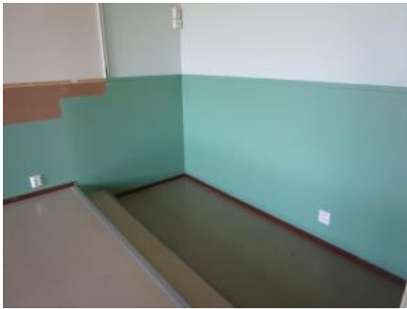
Kuva 62. Vaarallinen ja korjattava asennus. Maadoitettu ja maadoittamaton pistorasia liian lähellä toisiaan samassa tilassa.
