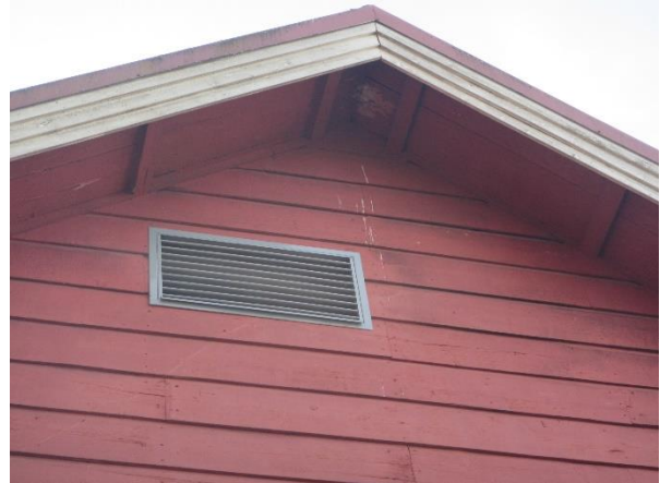
Kuva 47. Alakerran ilmanvaihdonkoneiden (2 kpl) raitisilmäaleikkö rakennuksen päädyssä.
