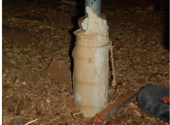
Kuva 25. Arviolta asbestipitoinen vanha putkieriste yläpohjatilassa.
