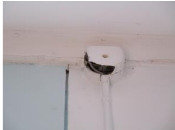
Kuva 63. Rikkoutunut jakorasia, jännitteiset osat on kosketeltavissa. Korjattava asennus
