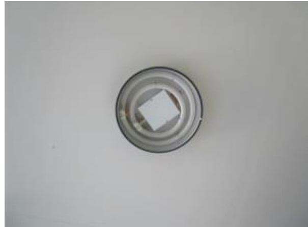
Kuva 65. Luokahuoneiden valaistuksessa on käytetty myös pyöreitä loisteputkivalaisimia
