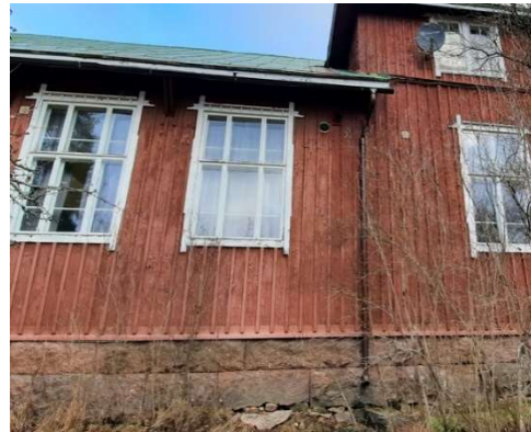
Julkisivumaalin hilseilyä laaja-alaisesti
