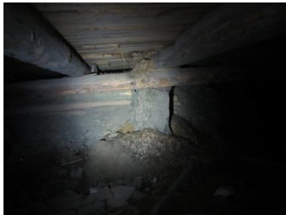
Kuva 14. Yksittäinen alapohjan sortuma alkuperäisen alapohjan osalla.
