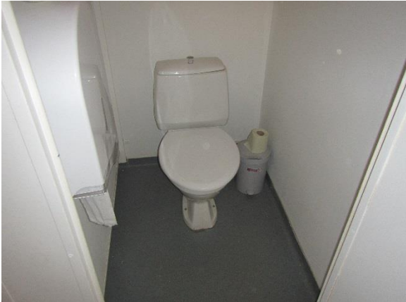
Kuva 71 WC-pöntöt ovat pääosin yksitoimisia
