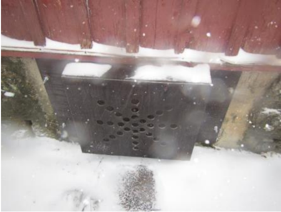
Kuva 19. Ryömintätilan puhallin alkuperäisellä osalla.
