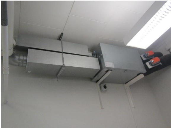
Kuva 77. Alakerran tiloissa olevat ilmanvaihtokoneet ovat kuvan mukaisia
