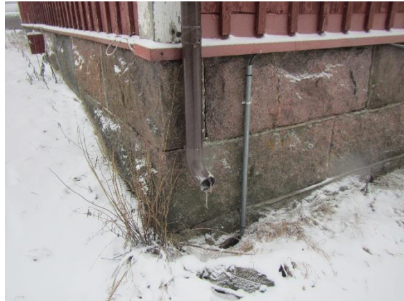
Kuva 76. Syöksytorvien alapäässä ei ole rännikaivoja ja lisäksi se on lyhyt, mistä johtuen roiskuva vesi kastelee sokkelia
