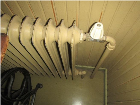
Kuva 65. Alkuperäinen liitepatteri, jossa käsisäästöventtiili
