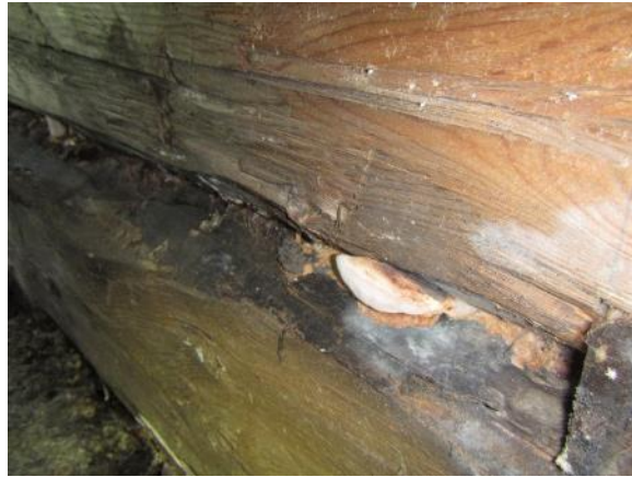
Kuva 28. Ullakon jiirin vuotokohdan alla on pidemmälle edennyt lahovaurio. Hirressä kasvaa lahosieni. Nurkan lohenpyrstösälvokset ovat kuitenkin ehjiä.
