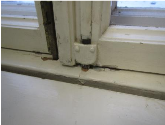
Kuva 35. Ikkunoiden sulkimille ei ole kunnon hahloja karmeissa.
