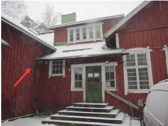
Kuva 75. Kattosadevedet vaativat nuolen osoittamassa kohdassa syöksytorven
