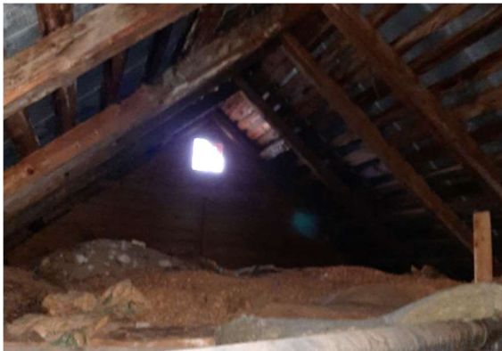
Suojaamattomasta tuuletusaukosta pääsee pieneläimet ullakkotiloihin, myös viistosade pääsee kastelemaan rakenteita esteettä.
