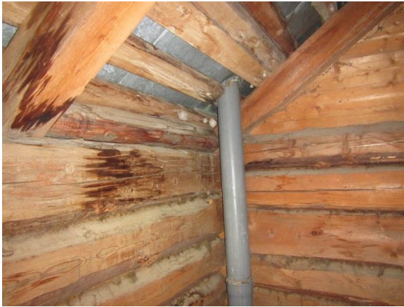
Kuva 47. Eristämätön viemärin tuuletusputki.
