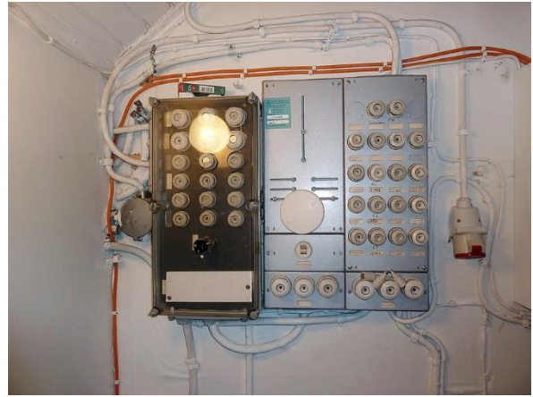
Kuva 88. Vanha pääkeskus alakeskuksena, n. vm. 1950.
