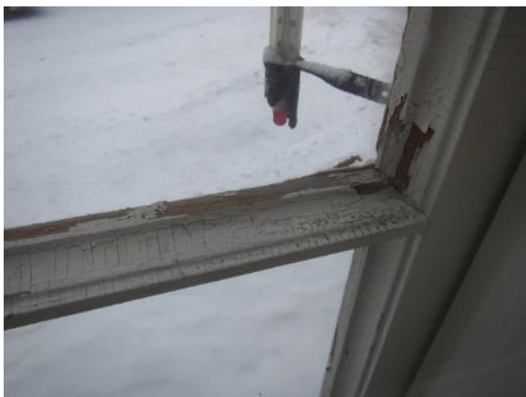
Kuva 33. Puitteiden välitilassa on maalipinnoitteissa vaurioita ja maalit halkeilee.
