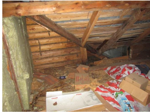
Kuva 48. Ullakolla paljon rakennusjätettä ja muuta romua.
