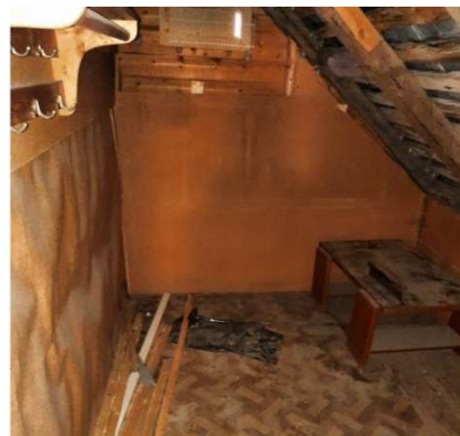
Aistinvaraisesti havaittavissa olevaa kosteutta ullakkotilan rakenteissa
