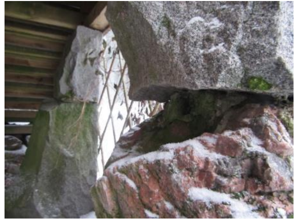
Kuva 44. Kivilatomuksen tuennat vaikuttivat riittämättömiltä.
