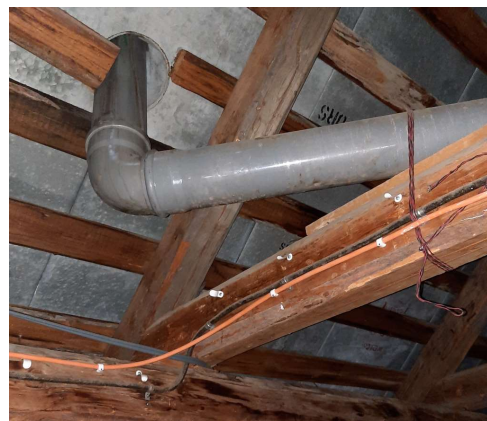
Eristämätön viemärin tuuletusputki, jossa kondensoituneesta kosteudesta johtuvia valumajälkiä.
