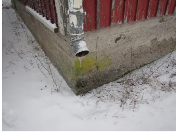
Kuva 12. Teräsbetonisokkelissa lievää pintarapautumaa.
