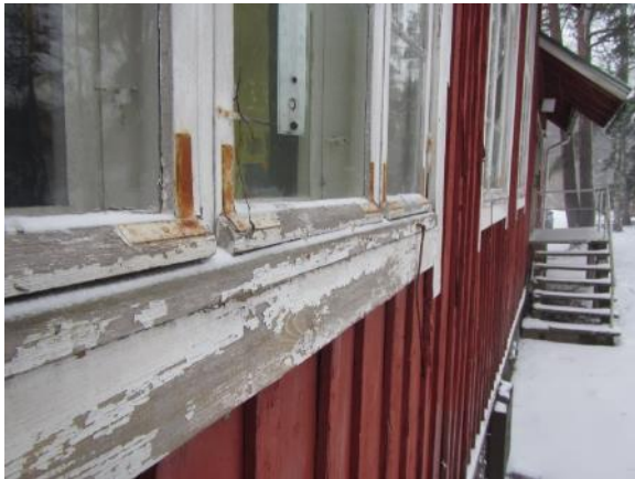
Kuva 31. Ikkunoiden ulkopuoliset maalipinnat ovat kuluneita ja kittaukset halkeilevat. Myös kulmaraudat ovat ruosteessa.
