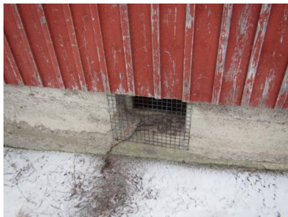
Kuva 18. Laajennusosan tuuletusluukku ja harva verkotus.
