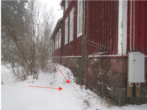
Kuva 4. Lämmönjakuhuoneen oven edessä on syvennys, joka kerää sadevesiä.
