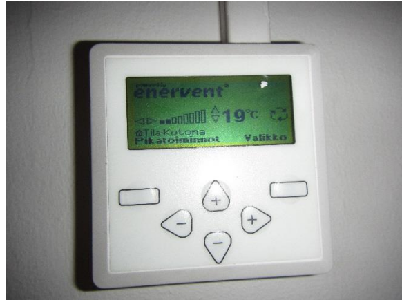
Kuva 78. Ilmanvaihtokoneita ohjataan ohjainpaneelien avulla
