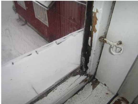
Kuva 32. Paikoin ulkopuitteet ovat lahoja.
