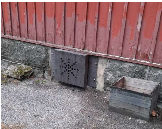
Alkuperäisen osan ryömintätilan poistoilmapuhallin
