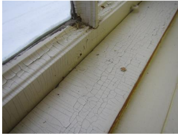
Kuva 36. Maalipinnat ovat paksuja ja halkeilevat.
