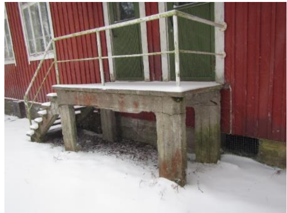
Kuva 42. Porraskorkeus on huonokuntoinen.
