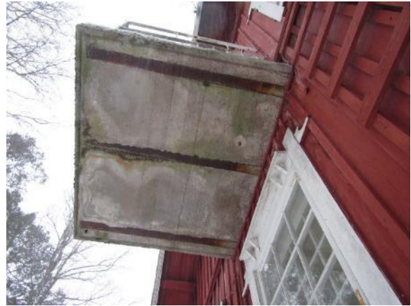
Kuva 40. Parvekelaatta on huonokuntoinen.
