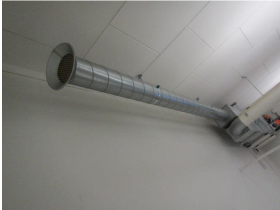
Kuva 81. Poistoilmakanava ja -pätelaite
