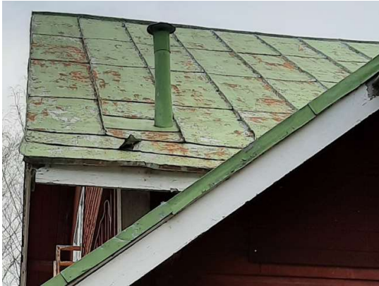
Vesikatteen paikallinen vaurio ja korroosiovaurioita
