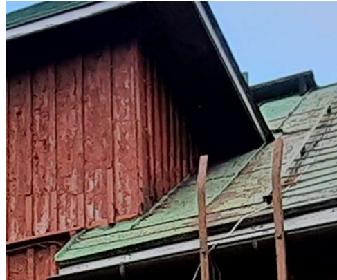
Vesikatteen ylösnosto puutteellinen
