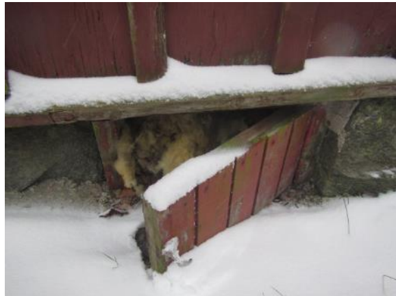
Kuva 3. Pitkän seinän osalla, maanpinnat ovat myös ajan saatossa kohonneet, sillä sokkelinluukut ovat maanpinnan tasossa.
