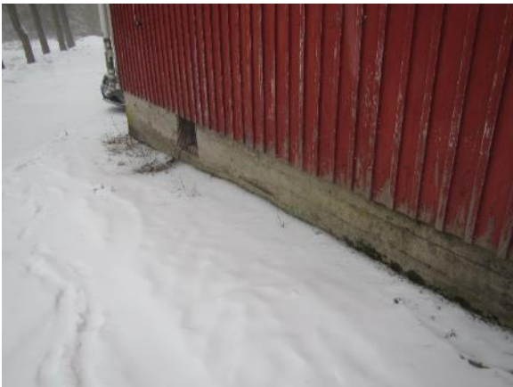
Kuva 29. Julkisivuverhoukset ovat ehjiä, mutta maalipinnat ovat kuluneita.
