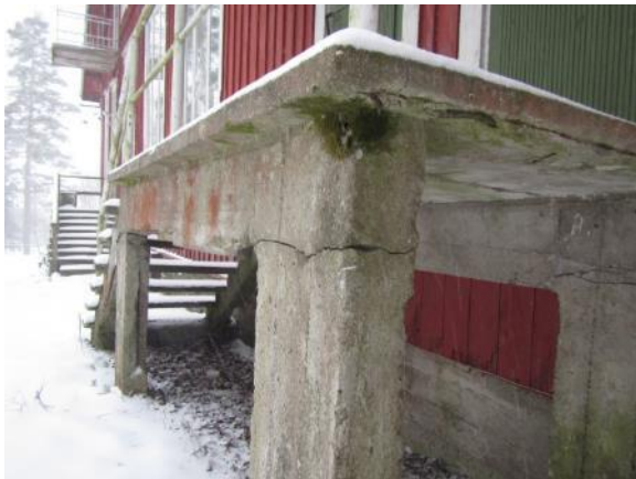
Kuva 41. Porraskorkeus on pahoin vaurioitunut.
