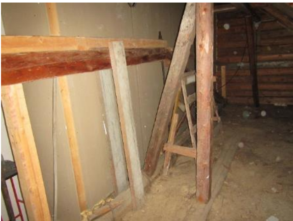
Kuva 25. Ullakon toista vetotankoa on paranneltu. Vetotanko vaikuttaa stabiililta. Muutama korjausosa oli tarpeeton, sillä ne eivät ottaneet mekaanista rasitusta vastaan.
