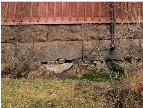
Julkisivun maalipinta on pahoin hilseillyt
