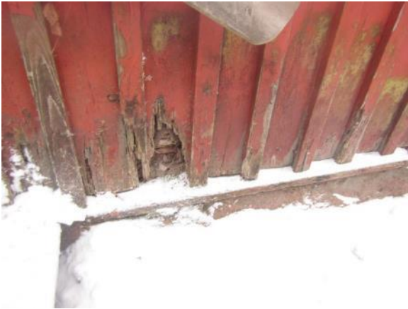
Kuva 27. Hirsirungon paikallinen vauriokohta, joka johtuu kattovesien ohjauksesta.
