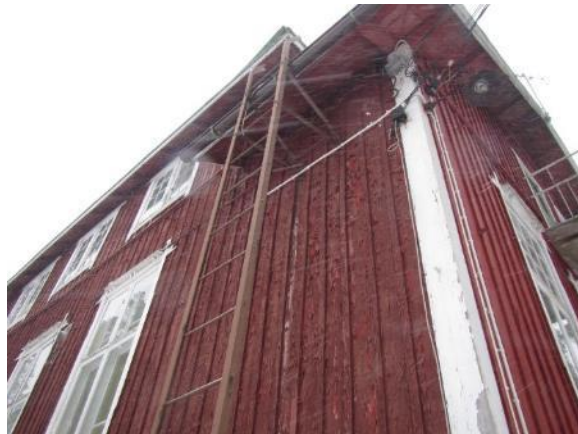
Kuva 30. Varsinkin eteläjulkisivulla maalipinnoitteet ovat huonokuntoisia.
