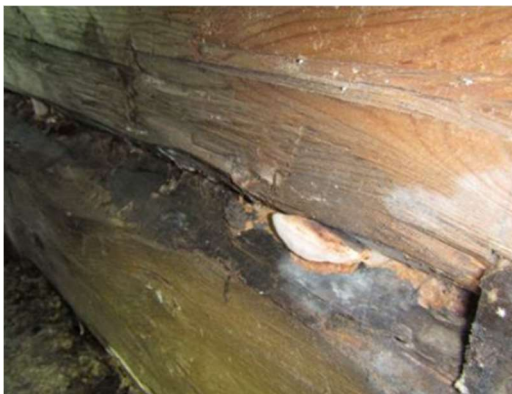
Vesikatteen jiirivuodon aiheuttama lahottajasienikasvusto (WSP Finland Oy 2018).
