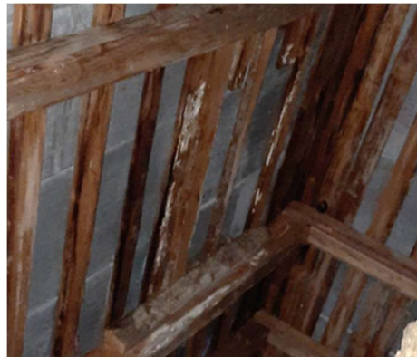
Kondensoituneen kosteuden aiheuttaman rasituksen jälkiä vesikaton alusrakenteissa.
