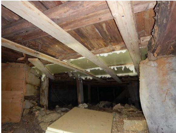
Kuva 17. Lahovaurioituneita alapohjarakenteita. WC-tilan kohdalle on asennettu eristelevyt.
