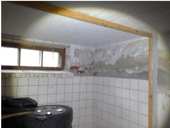
Kuva 18. Perusmuureissa on havaittavissa jälkiä voimakkaasta kosteusrasituksesta. Kuva rakennuksen eteläpäädyistä.
