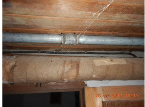
Kuva 100. Kylmävesijohto sinkittyä teräsputkea
