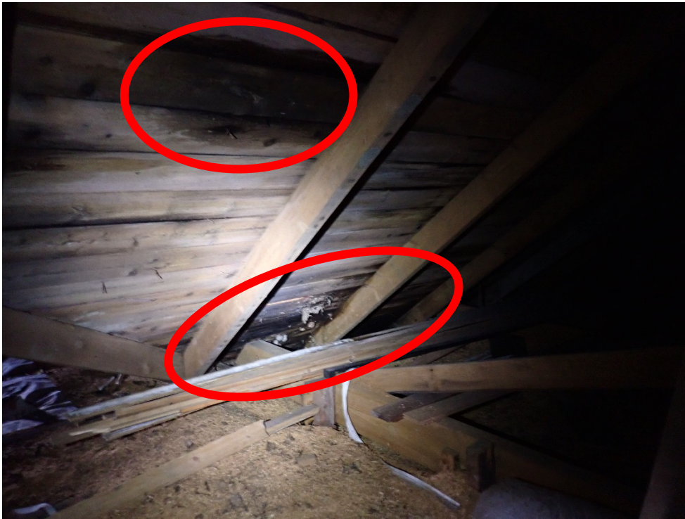
Puurakenteet ovat kauttaaltaan harmaantuneet. Tämä viittaa tuuletuksen heikkouteen. Mustat alueet ruoteissa on merkkiä kattovuotoja.
