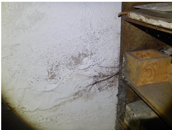
Kuva 28. Lahottajasienien rihmastoja kellarin seinässä.
