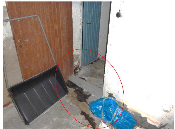
Kuva 23. Maanvastaisessa alapohjarakenteessa on silminnähävää sienikasvustoa sekä merkkejä pitkäkestoisesta kosteusrasituksesta.
