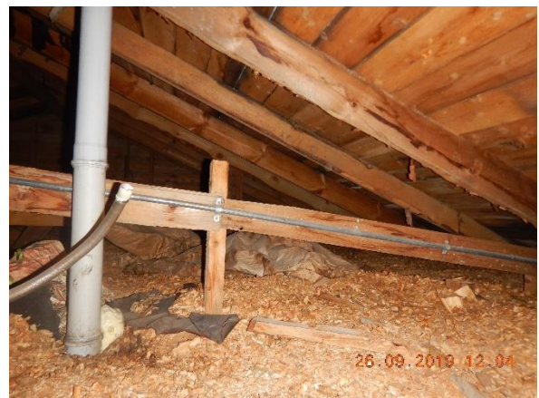
Kuva 23. Vuotojälkiä viemärin tuuletusputken läpiviennin kohdalla.
