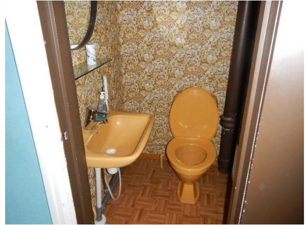
Kuva 72. 2. kerroksen wc-tila. Seinät ovat tapetoituja.
