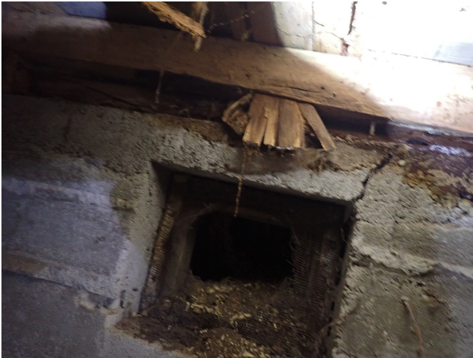
Talon alla on yhtenäinen välisokkeli, jossa 2 kpl tuuletusaukkoja.
