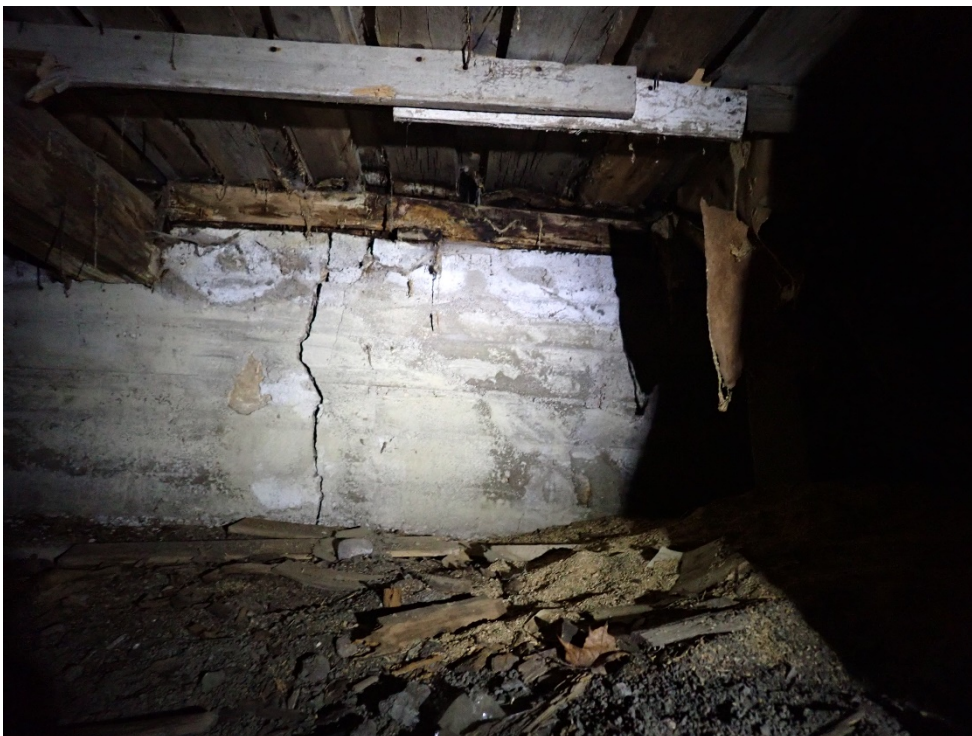
Sokkelissa halkeamaa ja sienikasvustoa.
