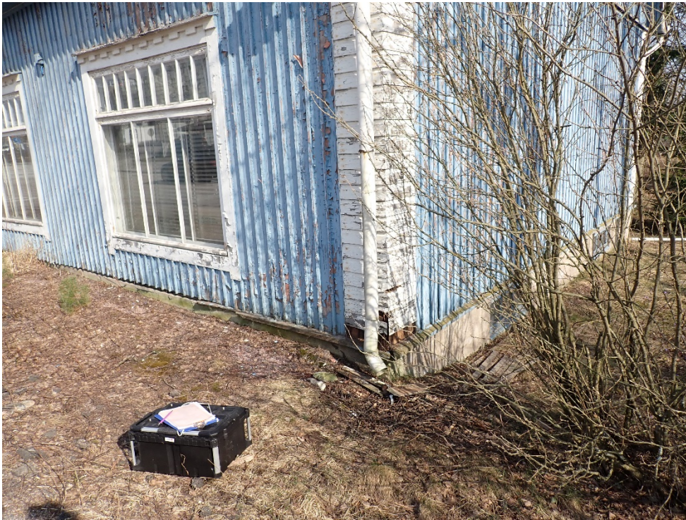
Kuvassa nurkasta vasempaan on Iso Kylätien puoleinen lännen puoleinen sivu, jossa sokkeli häviää maan alle rakennuksen keskivaiheilla.
