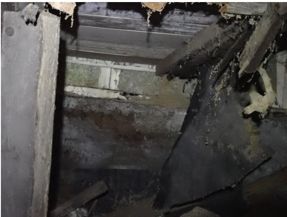
Romahtanutta alapohjaa. Kuvan keskellä näkyy sokkeli, jossa näyttäisi olevan mahdollisesti lattiasienikasvustoa. Seinää on korjattu muutama vuosi sitten. Tämä korjattu seinäosuus on pohjoispäädyssä koillisnurkan vieressä. Seinässä on mineraalivillaeristys.
