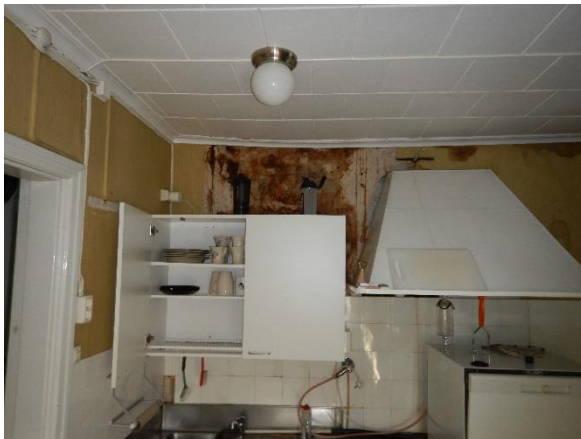
Kuva 75. Toisen kerroksen muurin rappaus on kosteusvaurioitunut tiivistämättömän piipun läpiviennistä valuneen veden takia.
