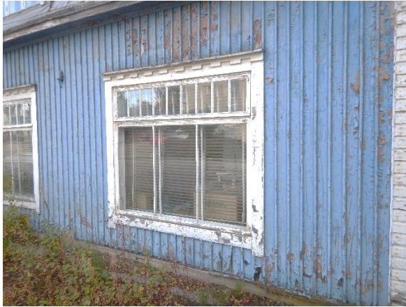
Kuva 16. Iso Kylätien puolella rakennuksen sokkeliä on näkyvissä vain muutama senttimetri. Ryöminätillaisen alapohjan tuuletusluukut ovat jääneet maanpinnan alle.
