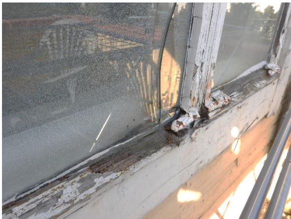
Kuva 46. Parvekkeen ikkunan alapuiteessa on pitkälle edennyttä lahoa. Ikkunalasi on särkynyt.
