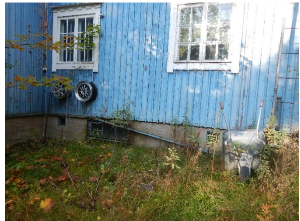
Kuva 44. Helmalaudoitus on lahovaurioitunut.
