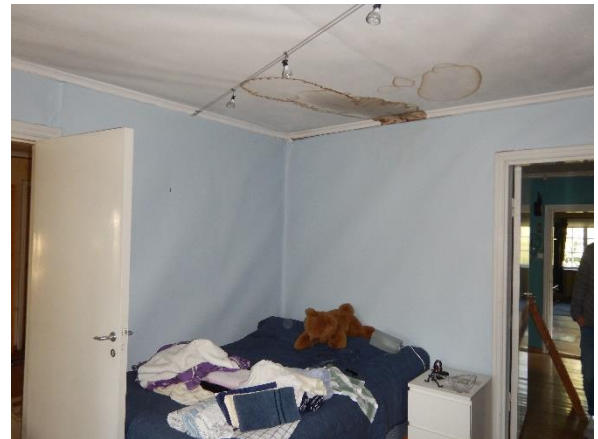
Kuva 76. Toisen kerroksen asuinhuoneen katossa on vesivuotojälki.
