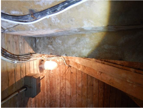
Kuva 73. Toiseen kerrokseen johtavat portaat on alapuolelta verhoiltu levytyksin. Levyt ovat mikrobivaurioituneet kosteuden vaikutuksesta.
