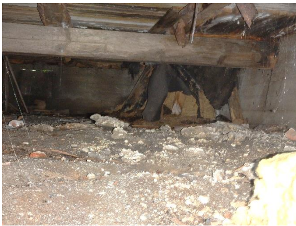
Kuva 20. Alapohjarakenne on lahovaurion vuoksi romahtanut.
