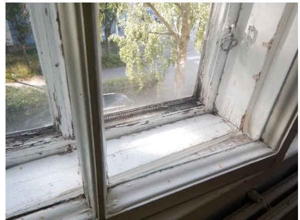
Kuva 47. Eteläpäädyn toisen kerroksen ikkunoiden ulkupuitteiden sisäpinnalla on havaittavissa kosteusjälkiä.
