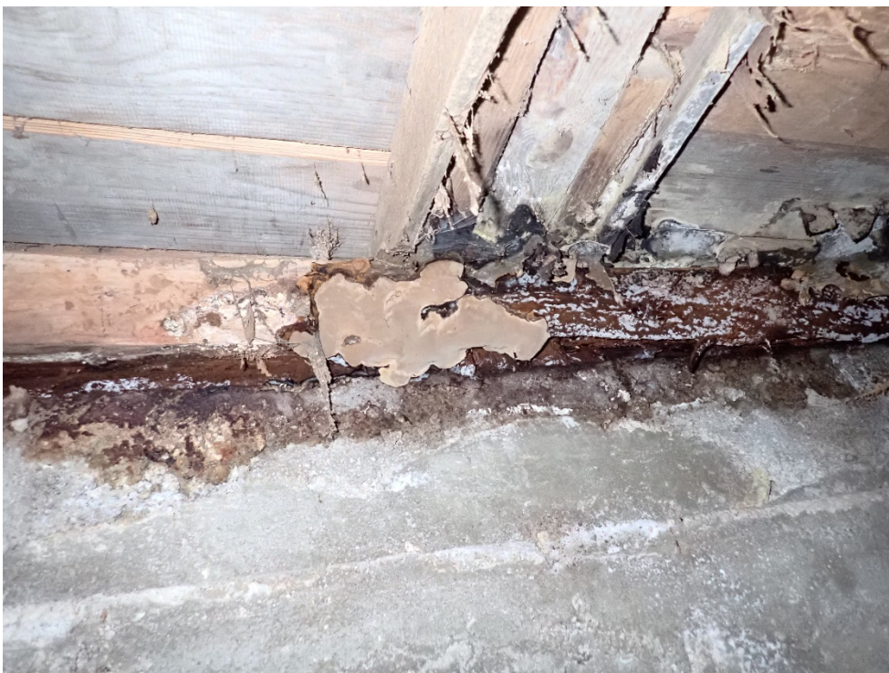
Oletettavasti lattiasienikasvustoa sokkelissa, alaohjauspuussa ja alapohjassa.
