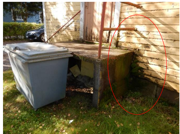
Kuva 31. Porrastasanteelta sade- ja sulamisvedet valuvat kohti ulkoseinää, johon on muodostunut lahovaurio.
