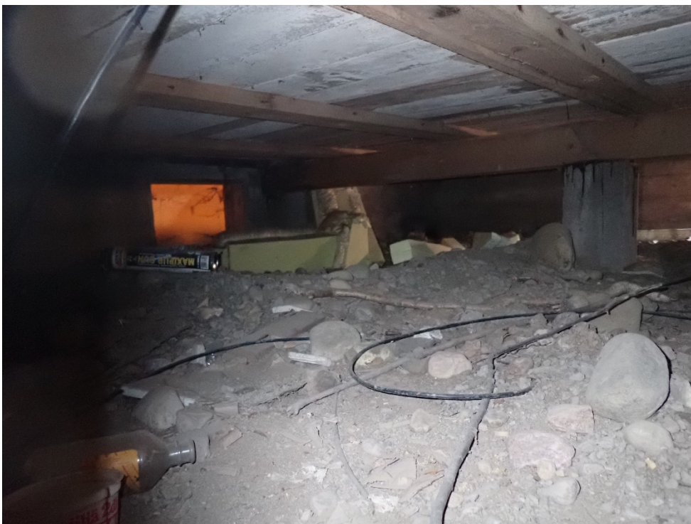
Kunnoltaan parasta ryömintätilaa takaovellisen varastuhuoneen alta. Tämäkin homeessa, mutta ei lahoja näkyvissä.
