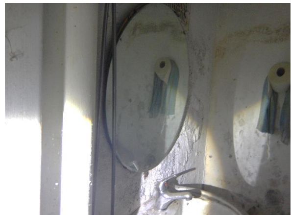
Kuva 29. Kellarin wc-tilan seinän pinnoite on kosteusvaurioitunut.
