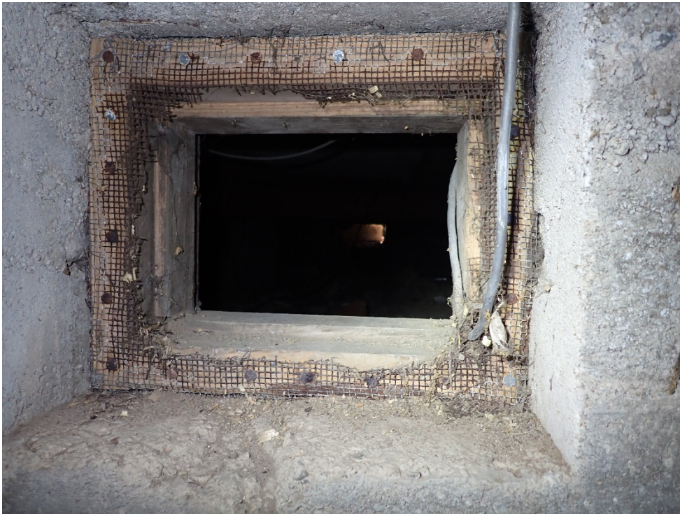
Rakennuksen keskellä oleva yhtenäinen sokkeli ja siinä oleva tuuletusaukko verkolla viittaa siihen, että rakennus saattaa olla laajennettu. Tässä tuuletusaukon kehikossa on profiilia luukkua varten.
