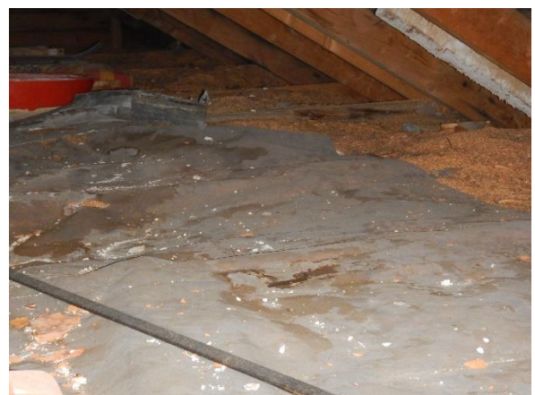
Kuva 37. Eristeiden päälle levitetyn peitteen päällä on vuotojälkiä. Asuintiloista yläpohjatilaaan tuleva kosteus
