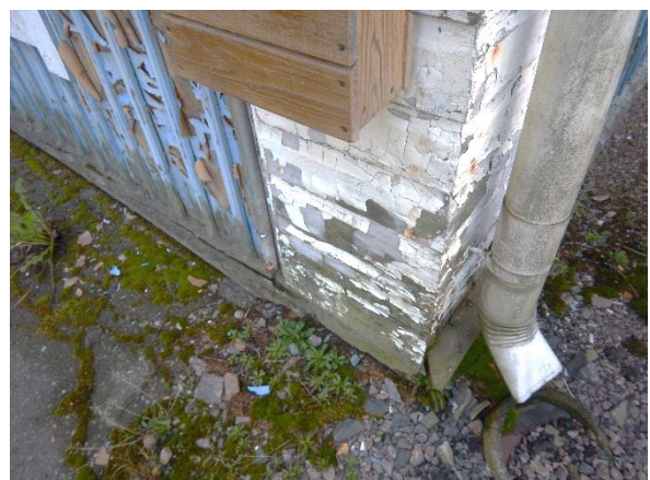
Kuva 50. Seinän alaosa on monin paikoin joko maanpinnan tasalla tai sen alapuolella. Seinä alaosan
