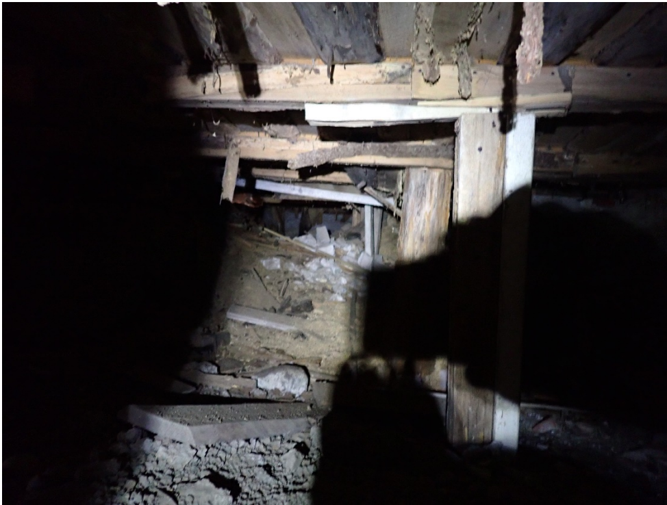
Alapohjassa on useista kohdista sortuneet eristeet alas. Alapohja on joskus jälkeen päin tuettu.
