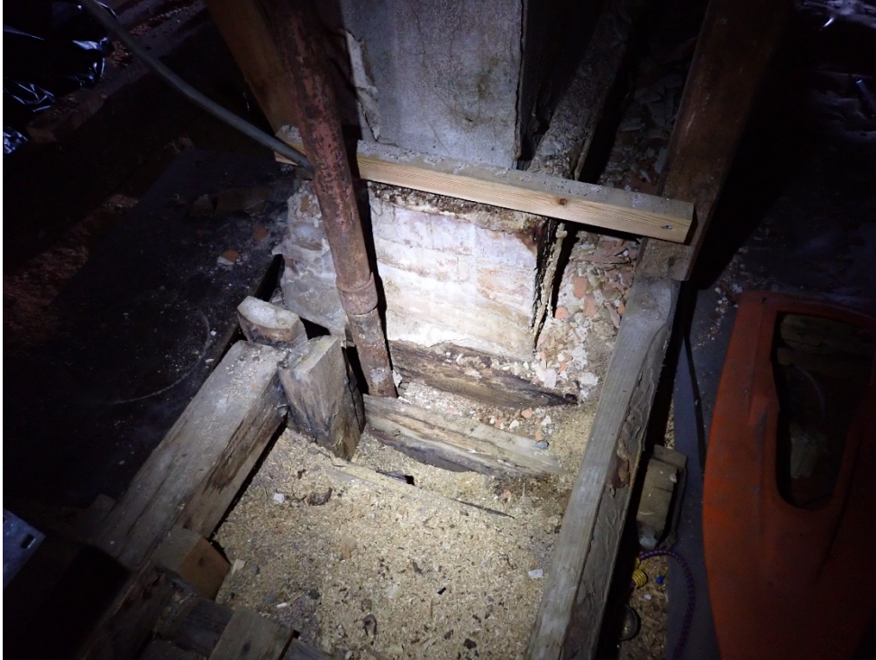
Yläpohjan kantavissa rakenteissa lahovaurioita piipun juuressa.
