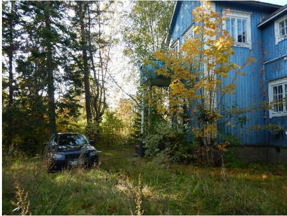
Kuva 45. Pesasistutukset ovat kiinni julkisivussa.
