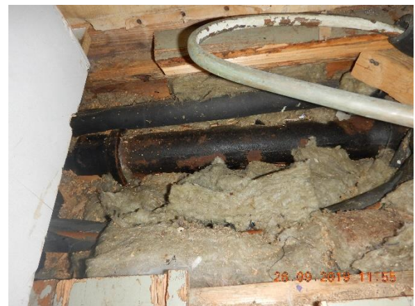
Kuva 82. Muhvillista valurautaviemäriä keittiön lattiassa
