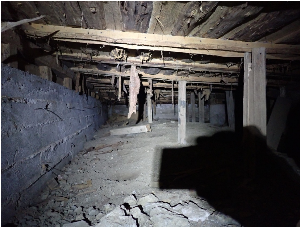
Sokkelit näyttävät suorilta ryömintätilasta katsoen. Ryömintätilassa on savipohja.
