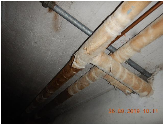
Kuva 91. Eristettyjä lämpöjohtoja kellarissa. Eristeet saattavat sisältää asbestia.
