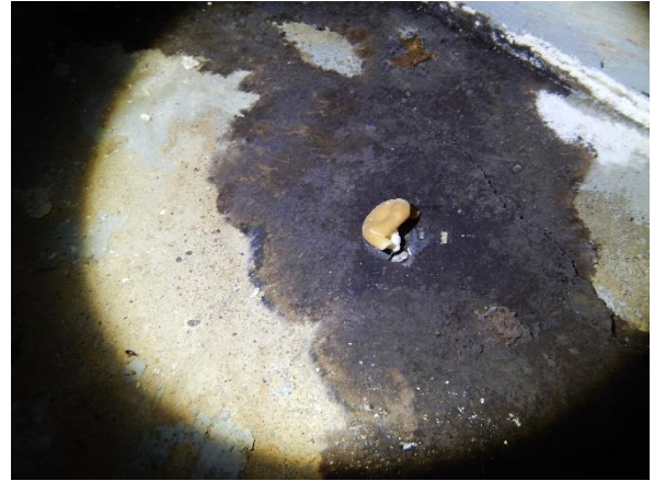
Kuva 25. Sienikasvustoa kellarin lattialla.
