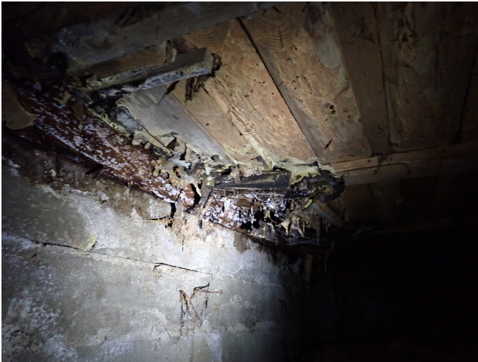
Tästä on alaohjauspuu hävinnyt jo lähes kokonaan. Lattiasieni valtaa pinta-alaa.
