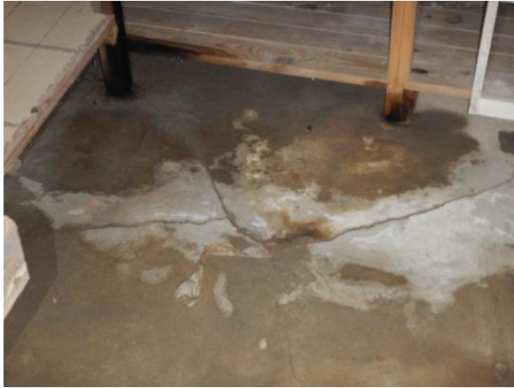
Kuva 24. Merkkejä veden lammikoitumisesta kellarin lattialla. Myös puurakenteisten hyllyjen alaosat ovat lahovaurioituneet.
