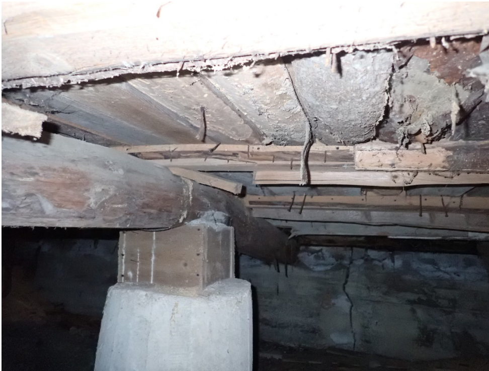
Alapohjan kannatinvasan pää on lahonnut kokonaan pois sokkelin päältä ja lattian paino on murtanut vasan pilarin kohdalta.
