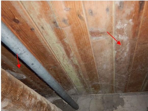
Kuva 30. Kellarin katon paneloinnit ovat aistinvaraisten havaintojen perusteella mikrobivaurioituneet.
