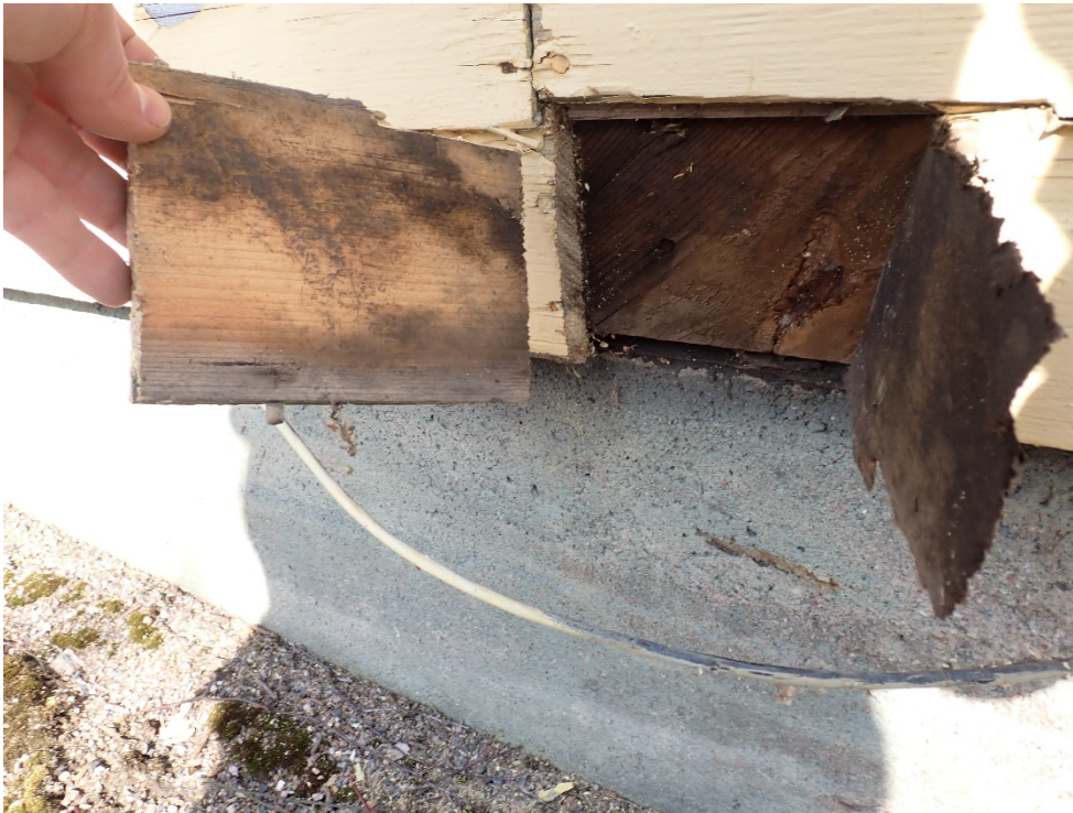
Eteläpäädyssä julkisivulaudoitus oli tällä kohdalla kovaa puuta, mutta vinolauta, tervapaperi ja julkisivulaudan takapinta ovat homeessa.
