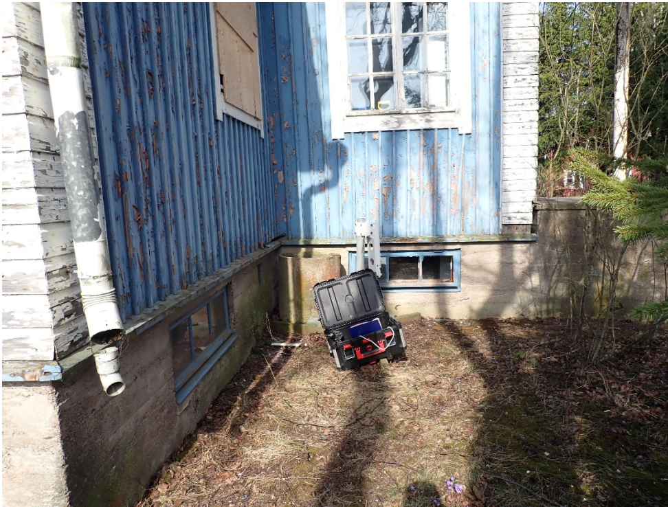
Tällä osuudella lahovaurioita ei ole kuin ulkonurkissa.
