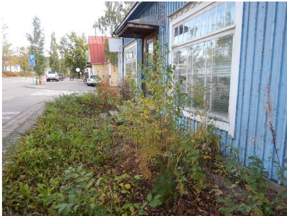
Kuva 2. Isokylätien puolella asfaltoidun katualueen ja rakennuksen välissä on sora- tai nurmikaista. Kasvillisuus on paikoin kiinni rakennuksen ulkoseinissä lisäten rakenteisiin kohdistuvaa kosteusrasitusta.
