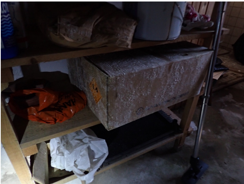
Kellarin ilmankosteus on ollut korkea, kun pahvilaatikkokin on näin pahasti homeessa.
