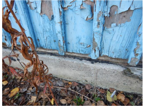
Kuva 46. Julkisivulaudoituksen alaoisissa on havaittavissa lahoa. Helmalista on lahonnut ja pudonnut.
