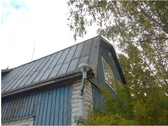
Kuva 9. Sade- ja sulamisvedet ohjataan jalkaränneillä syöksytorviin.
