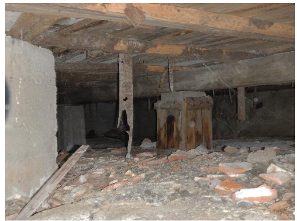
Kuva 21. Puista alapohjarakennetta tukevan betonipilarin muottilauδοitukset on jätetty paikoilleen. Muottilauδοitus on lahovaurioitunut.
