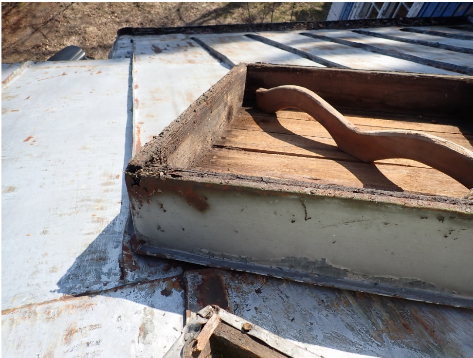
Kattopelleissä on ruostetta. Kattoluukun reunalaudat ovat lahonneet.
