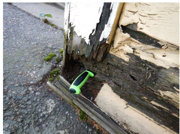
Kuva 37. Pitkälle edennyttä lahoa rakennuksen länsipuolella.
