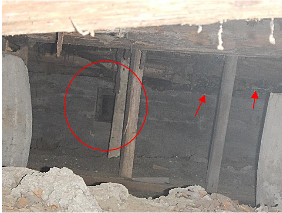
Kuva 15. Tuuletusluukut ovat jääneet maanpinnan alle rakennuksen länsipuolella. Nuolien osoittamassa kohdassa on aktiivista lahottajasienikasvustoa.
