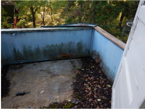
Kuva 60. Parvekkeen betoni on rapautunut. Kaiteessa on havaittavissa kosteusvauriojälkiä. Kaiteen pellitys on osittain irronnut.
