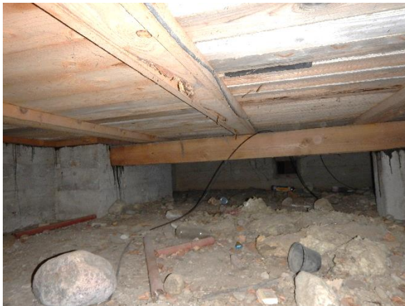
Kuva 13. Ryömintätilassa on roskaa. Kuva rakennuksen lounaiskulman alueelta.
