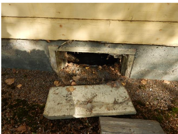
Kuva 19. Kohteessa havaittiin ainoastaan kolme rossitilan tuuletusluukkuja, joista kaksi oli suljettuna.
