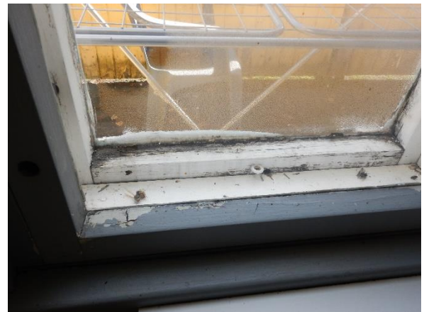
Kuva 45. Parvekkeen ikkunan ulkupuiteen sisäpinnalla on kosteusjälkiä.
