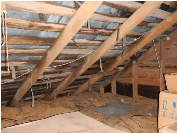
Kuva 34. Yläpohjatilassa on runsaasti roskaa. Kattoruoteissa on kosteusjälkiä.
