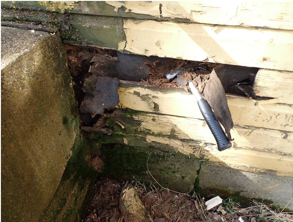
Takapihalla portaan vieressä seinä heikossa kunnossa.
