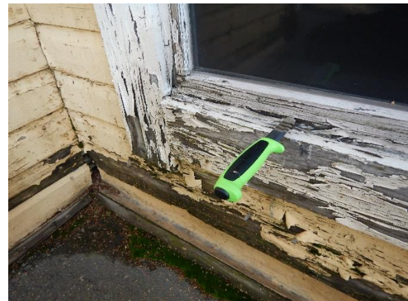
Kuva 41. Ikkunoiden alapuitteissa on lahovaurioita.
