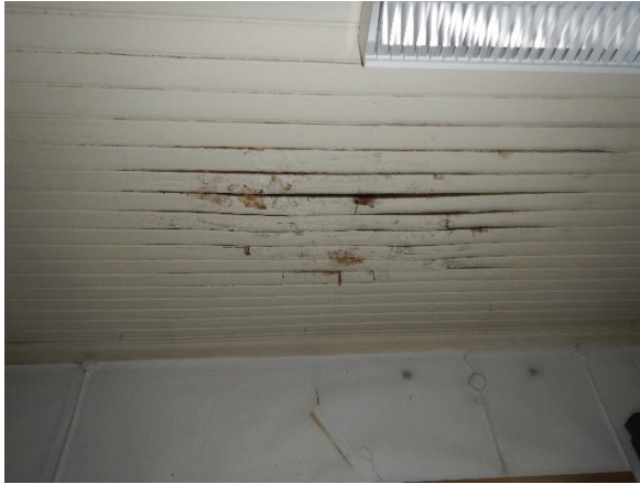
Kuva 79. Myymälän katossa on havaittavissa vesivuotojälkiä.
