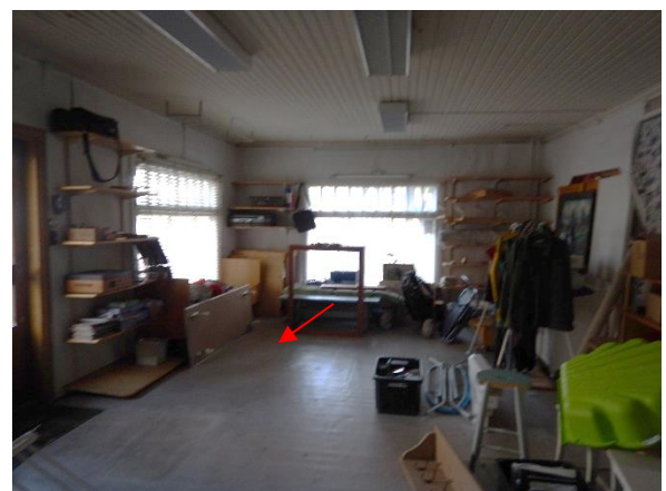
Kuva 78. Yleiskuva myymälähuoneesta. Lattia on romahtanut lahovaurion seurauksena nuolen osoittamasta kohdasta.
