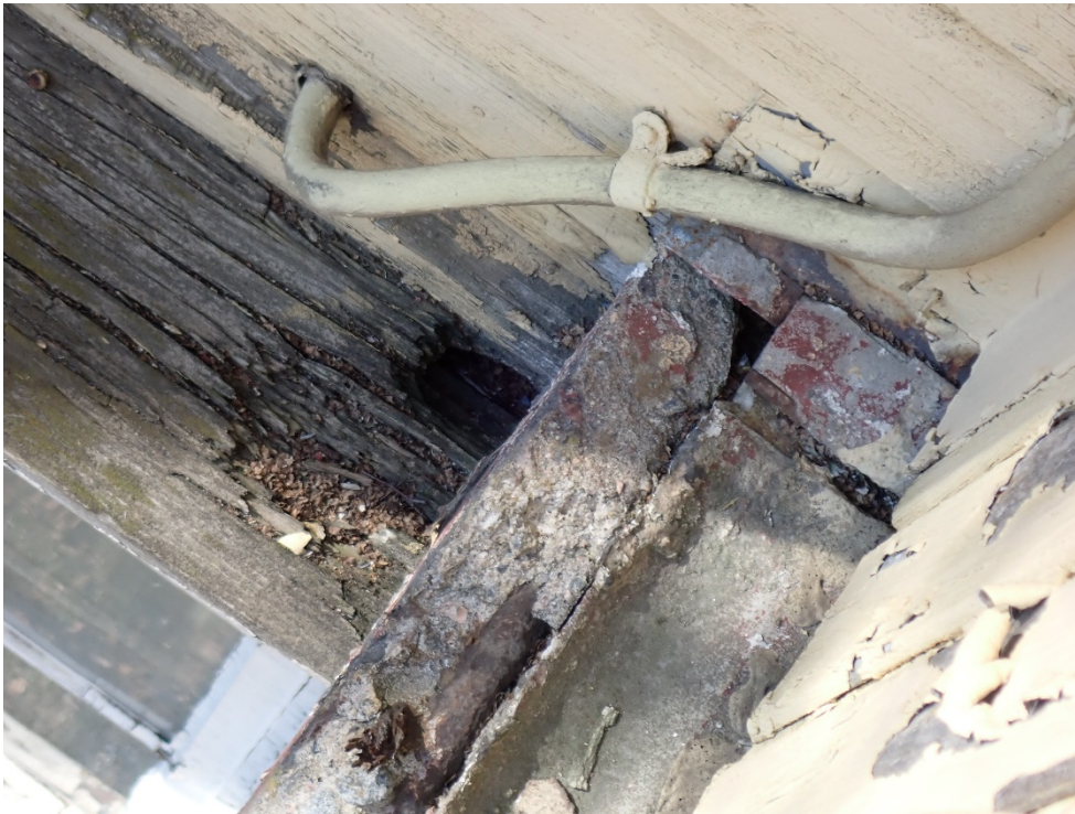
Parvekelaatan reunaa ja ikkunan yläpuolen vesilautaa.
