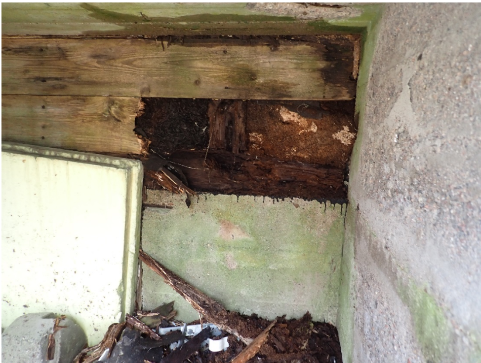
Takapihalla portaan alla seinä laho.
