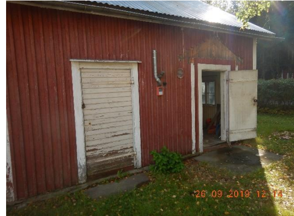
Kuva 6. Piharakennuksessa on lämmönjakohuone, joka sijaitsee kuvassa oikealla.
