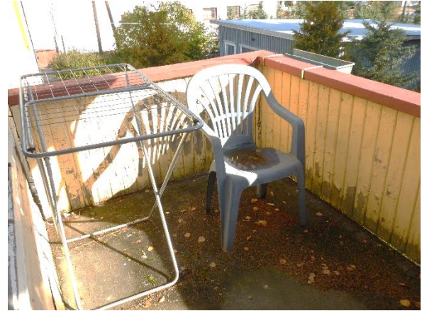
Kuva 52. Parvekkeen lattia on betonia. Puukaiteet ovat lahovaurioituneet.
