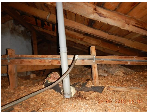
Kuva 81. Muovinen tuuletusviemäriputki yläpohjatilassa
