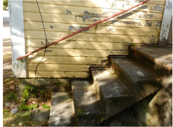
Kuva 33. Betonirakenteinen portaikko ohjaa sade- ja sulamisvedet kohti ulkoseinää. Ulkoseinään on muodostunut lahovaurio.
