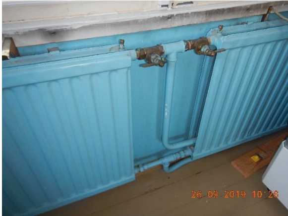
Kuva 93. Alkuperäisiä teräslevypattereita ja venttiilejä
