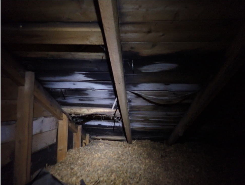
Tässä oletettavasti vesikatossa vuoto kun ruodelaudat ovat poikkeavan värisiä.
