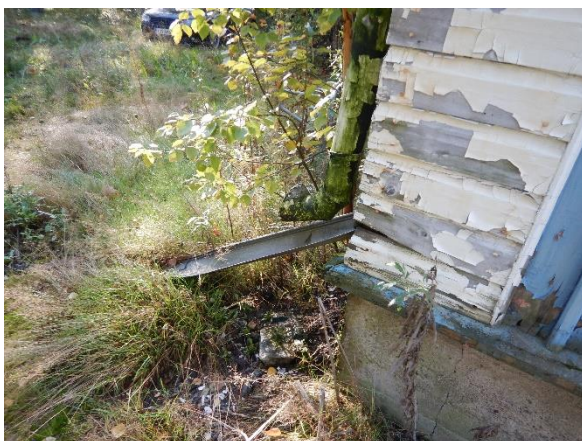
Kuva 13. Alkuperäisestä syöksytorvesta tuleva vesi on pyritty johtamaan kauemmas kourulla.
