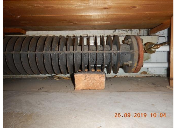
Kuva 94. Valurautainen ripaputkipatteri ja venttiili
