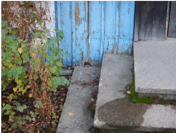
Kuva 47. Itäpuolen betoniportaait ohjaavat sade- ja sulamisveden ulkoseinää vasten, joka merkittävästi lisää ulkoseinärakenteeseen kohdistuvaa kosteusrasitusta.
