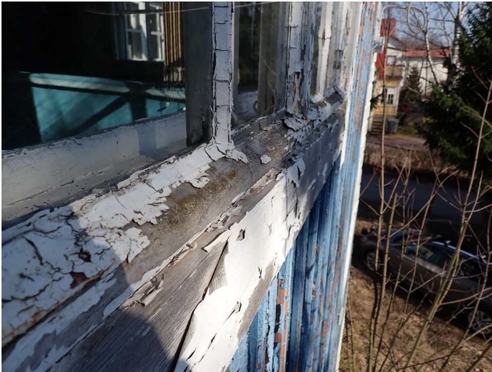
Ikkunoiden maalit ja kitit ovat huonokuntoiset. Puuosat kuitenkin ehjiä.
