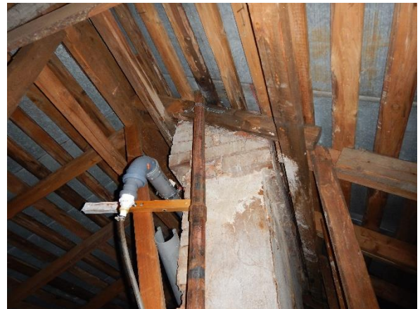
Kuva 35. Vuotojälkiä piipun läpiviennin kohdalla piipussa ja katon puurakenteissa.
