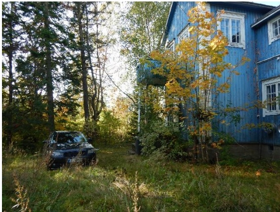
Kuva 4. Piha-alue on nurmipäällysteinen. Rakennuksen seinustoilla kasvaa puita ja pensaita lisäten ulkoseinärakenteisiin kohdistuvaa kosteusrasitusta.
