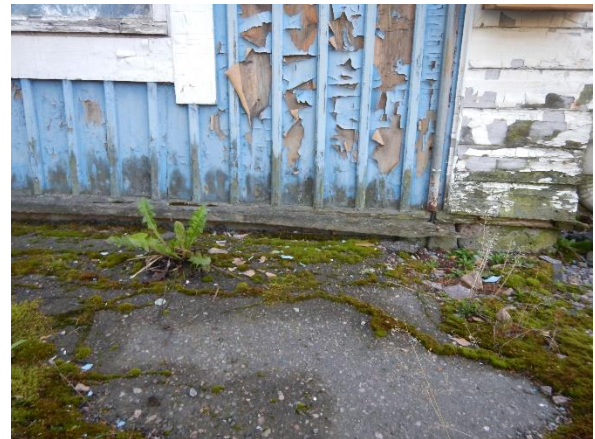
Kuva 15. Rakennuksen pohjoispäädyssä maanpinta on ulkoseinän alaosan tasalla. Sokkeli ja alapohjan tuuletusluukut ovat jääneet maanpinnan alle.
