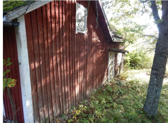
Kuva 8. Piharakennus on painunut ja seinän alaosa on jäänyt maanpinnan alapuolelle.
