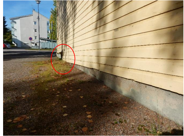
Kuva 10. Sokkeli on osittain jäänyt maanpinnan alle rakennuksen eteläpäädyssä.
