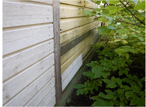
Kuva 39. Kasvillisuus on kiinni julkisivussa pohjoispäädystä lisäten julkisivuun kohdistuvaa kosteusriskiä.
