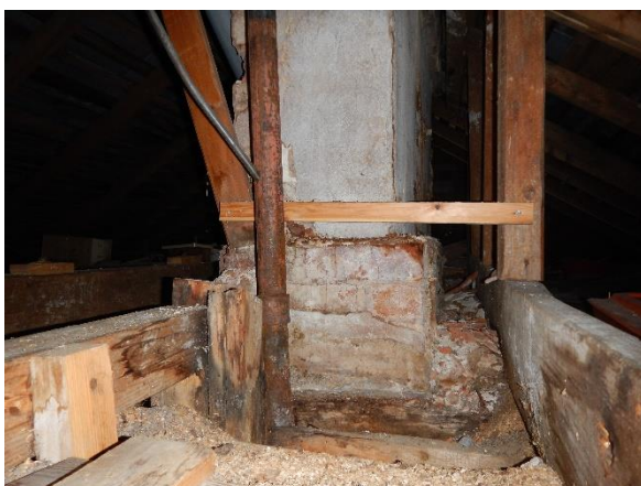
Kuva 36. Kantavissa puurakenteissa on vuotojälkiä. Piipun rappaus on karissut kosteuden vaikutuksesta.
