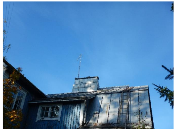
Kuva 65. Kohteeseen on asennettu talotikkaat ja kulkusilta katolle.
