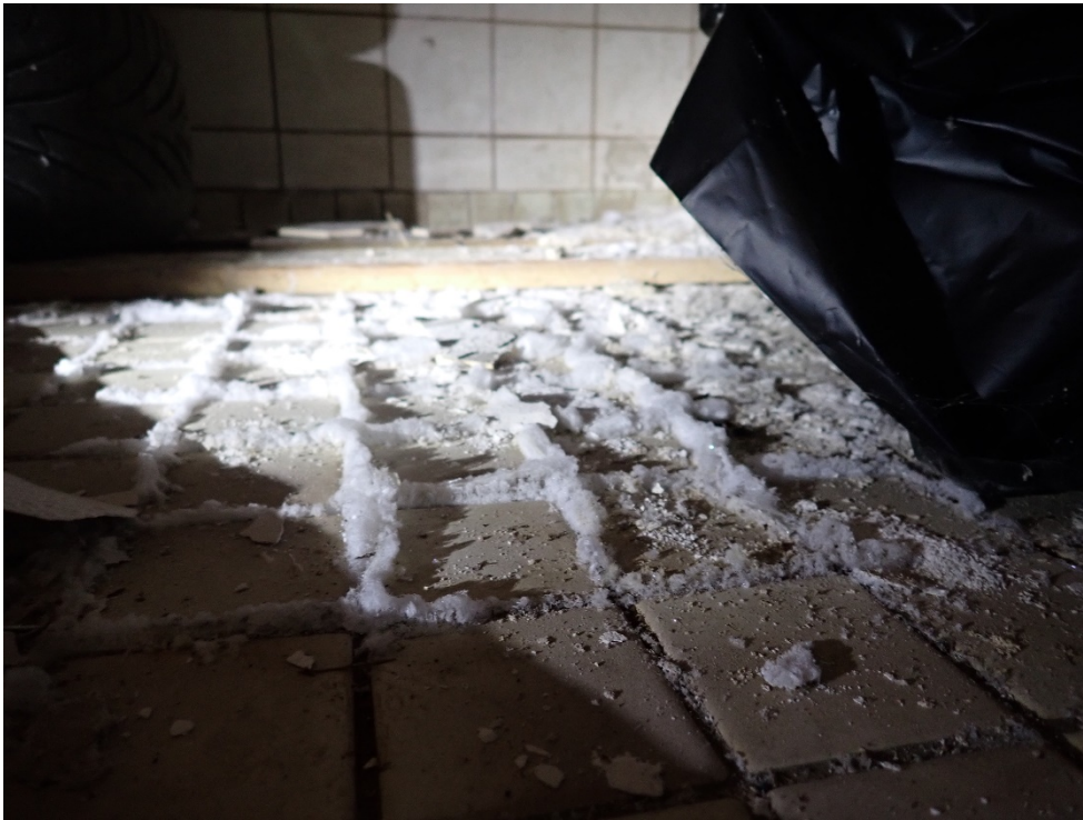
Kalkkihärmää kaakelisaumoissa. Betonialapohjan läpi kulkeutuva vesi kuljettaa suoloja. Kun vesi on haihtunut saumojen kohdalla, niin suolat ovat jääneet. Nämä kalkkihärmät ovat n. 10-20 mm korkeita.
