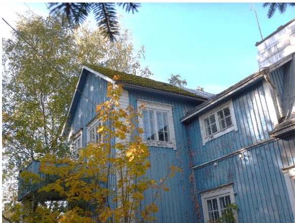
Kuva 64. Harjakatolla on runsaasti sammalkasvustoa.
