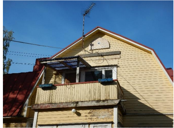
Kuva 8. Parvekkeelta katolta vesi valuu vapaasti sadevesikourusta.
