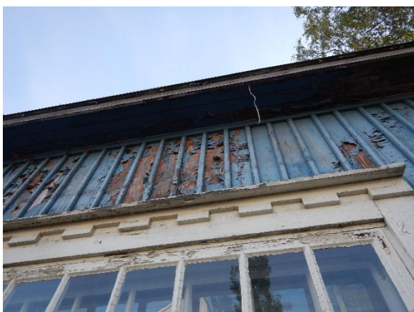
Kuva 49. Maalipinnoite lehteilee myös ulkoseinien yläosissa.
