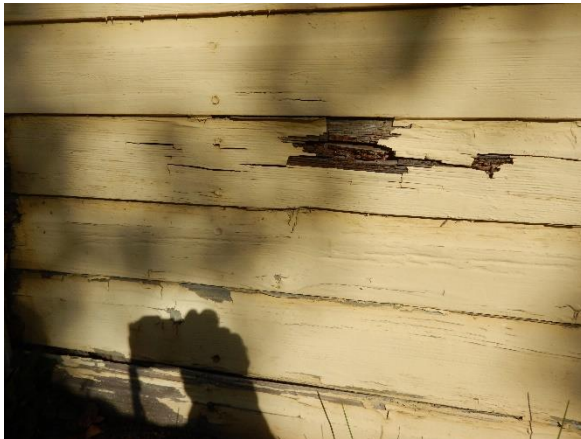
Kuva 34. Julkisivulaudoituksessa on havaittavissa lahovaurioitumista. Myös julkisivulaudoituksen taustan heikko tuulettuvuus kasvattaa vaurioitumisen riskiä.
