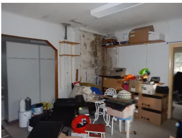
Kuva 77. Ensimmäisen kerroksen myymälätilan muuri on kosteusvaurioitunut
