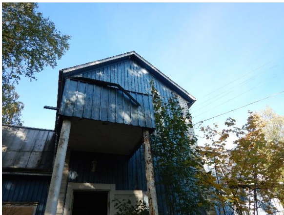
Kuva 41. Julkisivu idästä. Parvekkeen kaiteen pellitys on irronnut ja roikkuu parvekkeen ulkopuolella. Irtoavaan peltiin sisältyy henkilö- ja omaisuusriski.
