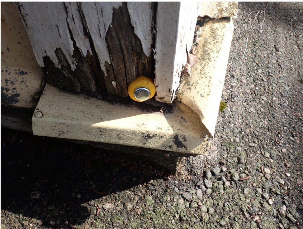
Etelän ja lännen välisellä nurkalla taltta upposi kokonaan seinän sisään sormella painaen.
