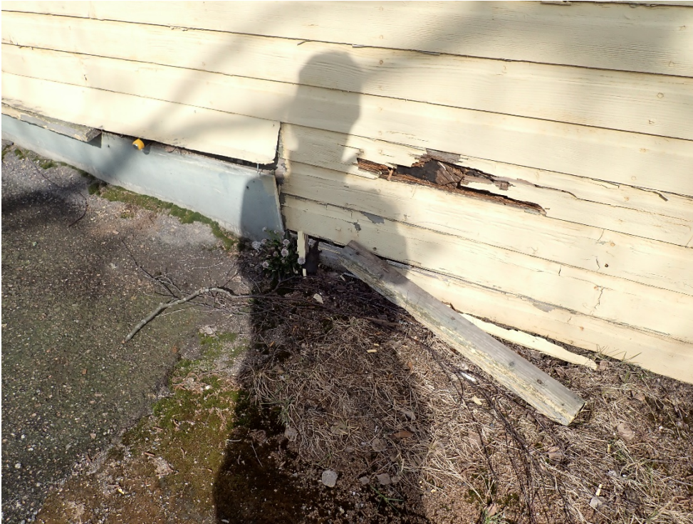
Etelän puoleisella seinällä lahovaurioita hieman ylempänäkin.
