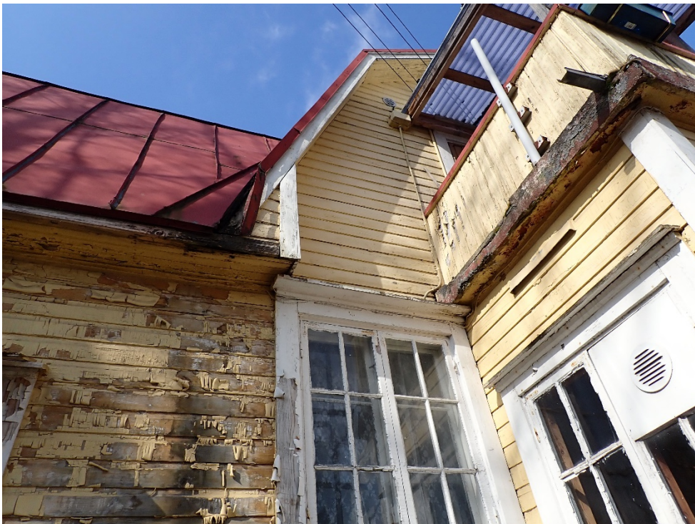
Kosteusvauriota räystäällä takaportaan päällä. Parvekelaatan etureuna rapautunut.
