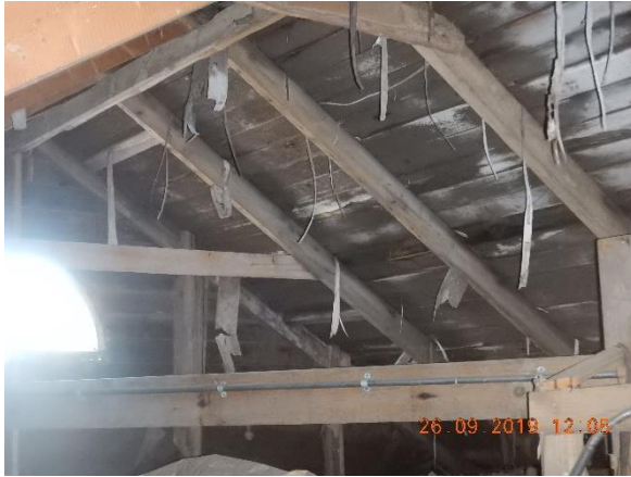
Kuva 24. Vesikaton puurakenteissa on vuotojälkiä.
