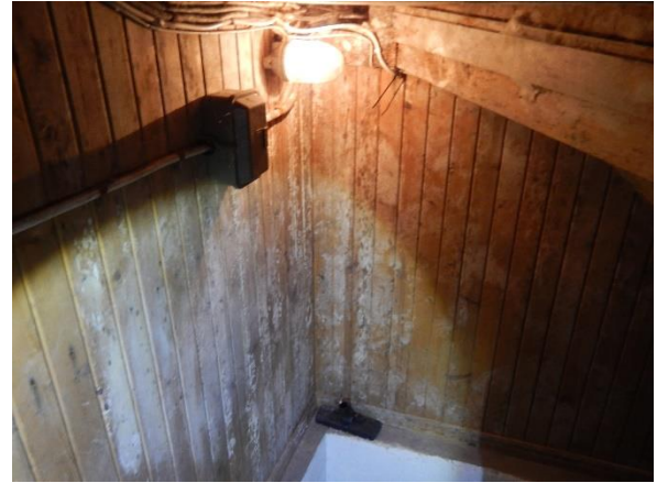
Kuva 74. Kellariin johtavan portaikon seinät on paneeloitu. Panelointi on mikrobivaurioitunut kosteuden vaikutuksesta.
