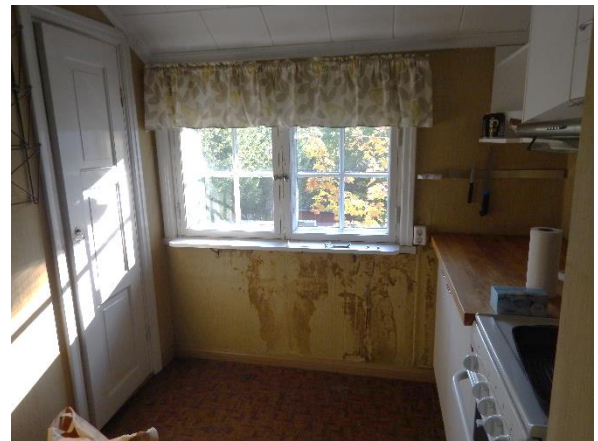
Kuva 82. Toisen kerroksen ikkunan alapuolella on havaittavissa vesivuotojälkiä.
