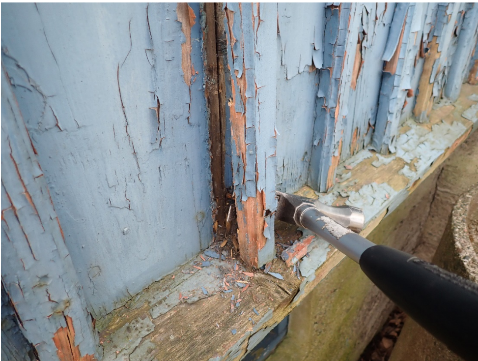
Julkisivulauδοitus on ponttilautaa. Rimojen takana ei ole tuuletusrakoa, vaan ponttilautojen saumat. Vaikka rimat ja laudat näyttävätkin huonoilta, ne ovat pääosin kunnossa alapäiden lievää haristumista lukuun ottamatta.
