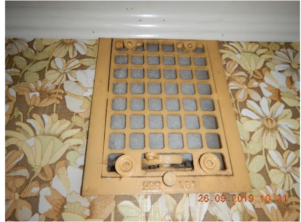
Kuva 106. Poistoilmasäleikkö jossa suodatinkangas
