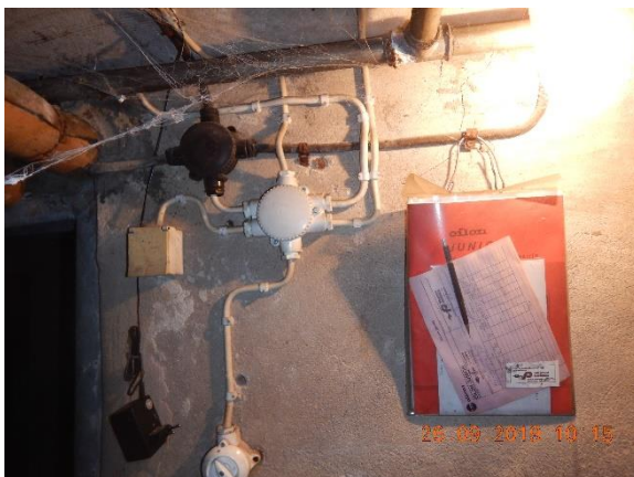
Kuva 109. Vanhoja asennuskalusteita. Pistorasia asennettu jälkeinpäin.
