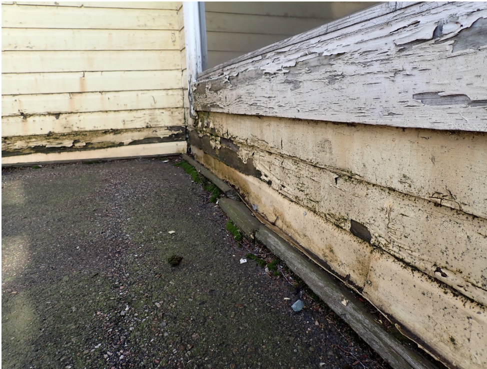
Kadun puoleista seinää. Asvaltti viettää paikoin seinää vasten. Sokkelin yläreuna on n. 40 cm asfalttia alempana. Seinä ja alapohja ovat tällä osalla aivan lahoa.
