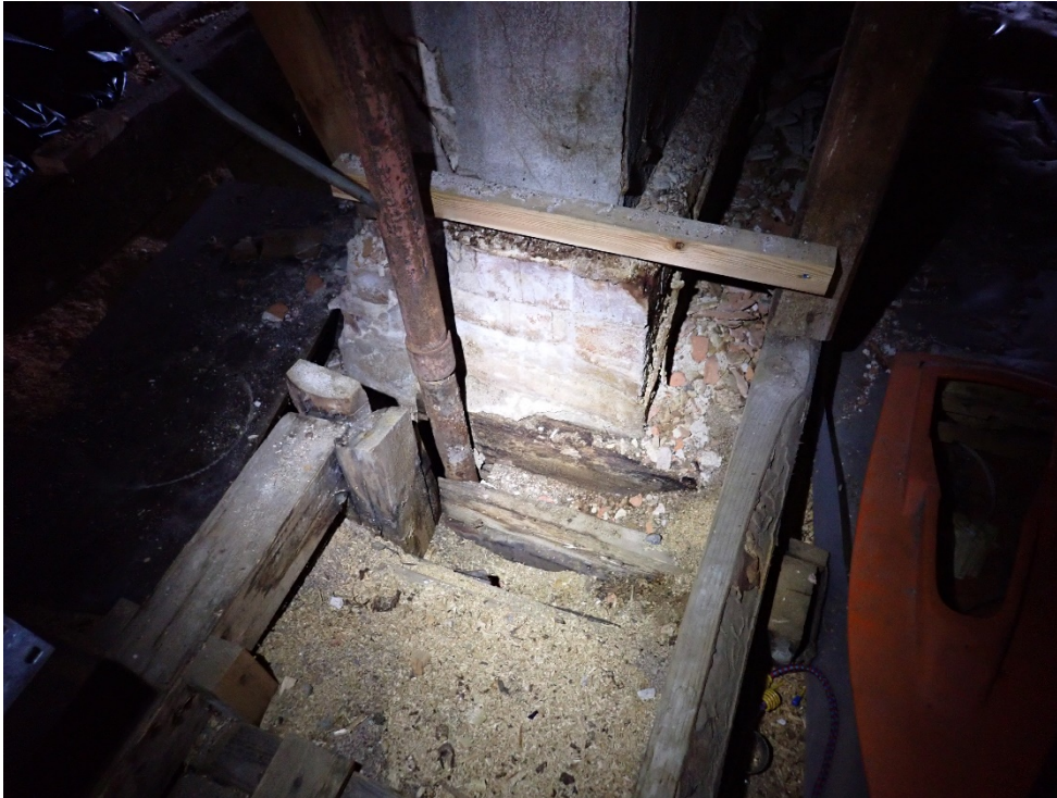
Yläpohjan kantavissa rakenteissa lahovaurioita piipun juuressa.
