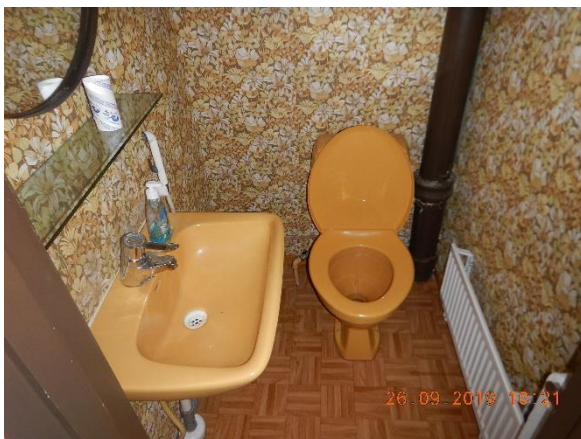
Kuva 101. Yläkerran WC-tilan vesi- ja viemärikalusteita
