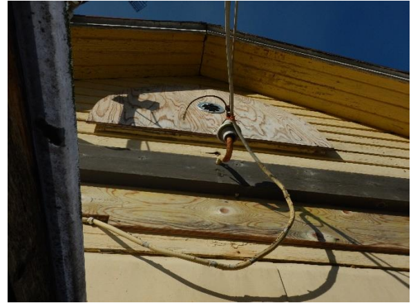
Kuva 25. Yläpohjan tuuletustas on tehostettu asentamalla tuuletussäleikkö ikkunan paikalle. Parannuksista huolimatta yläpohjan tuuletus ei ole riittävällä tasolla.
