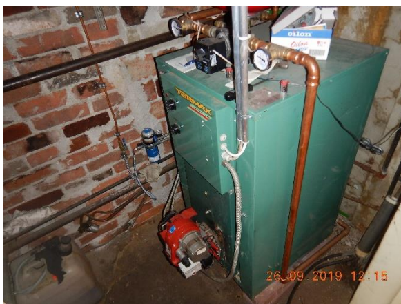
Kuva 73. Öljylämmityskattila ja poltin
