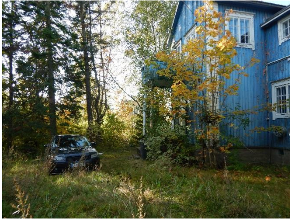
Kuva 45. Pesasistutukset ovat kiinni julkisivussa.
