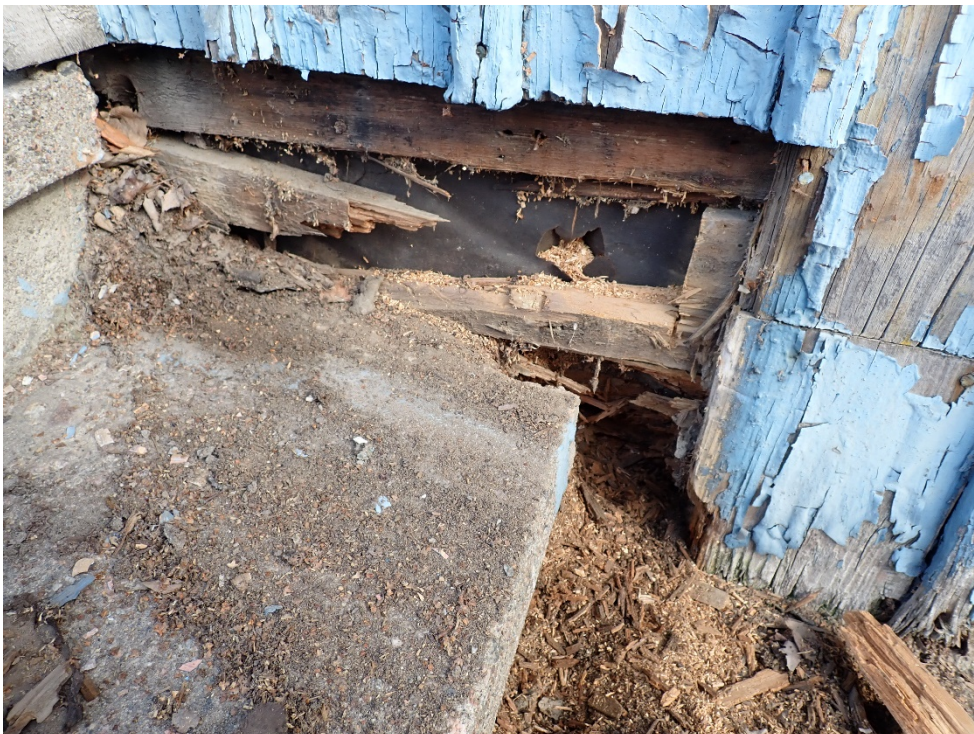
Kadun puoleisen sisäänkäynnin portaiden vieressä on seinän alaosa lahonnut.
