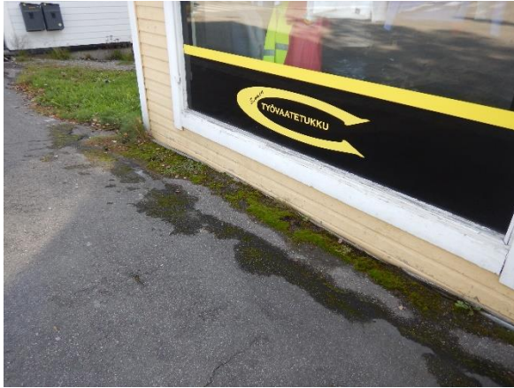
Kuva 38. Julkisivun alaosa on lahovaurioitunut kauttaaltaan rakennuksen länsipuolella.
