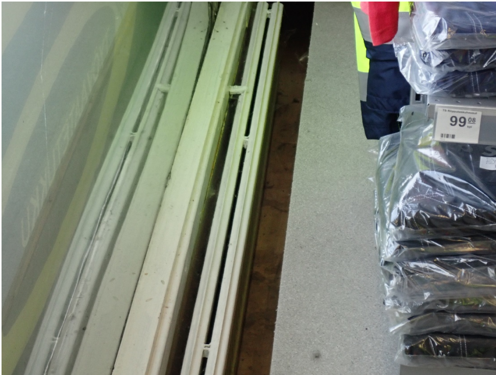
Liiketilan lattiaa on oikaistu niin paljon, että lämmityspatteri on nykyisen lattiapinnan tasalla.
