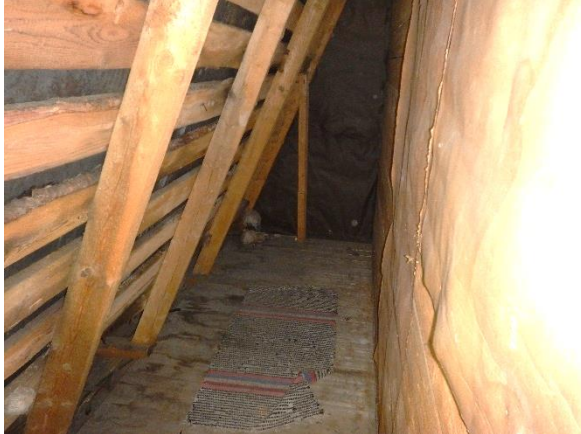
Kuva 38. Vesikaton lappeella olevassa varaston lattialaudoissa on havaittavissa kosteusjälkiä, joka ovat todennäköisesti muodostuneet peltikaton alapintaan tiivistyneen kondenssiveden valumista .
