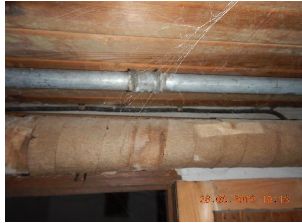
Kuva 100. Kylmävesijohto sinkittyä teräsputkea
