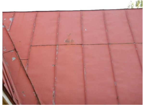
Kuva 54. Vesikatossa on havaittavissa ruostetta sekä maalipinnoitteen irtoamista.
