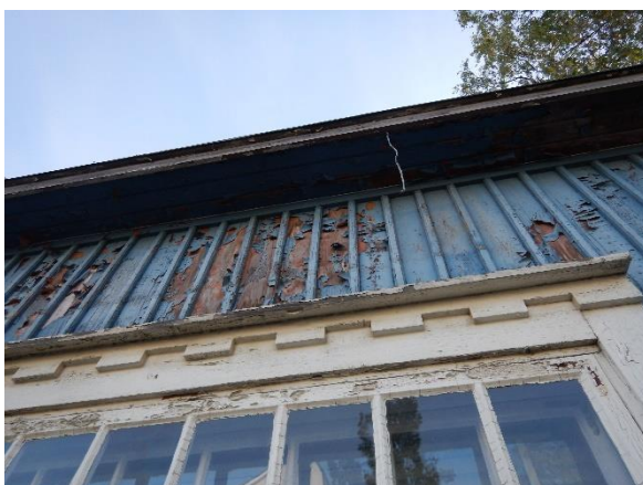
Kuva 49. Maalipinnoite lehteilee myös ulkoseinien yläosissa.
