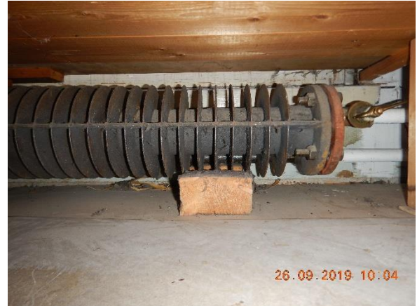
Kuva 94. Valurautainen ripaputkipatteri ja venttiili
