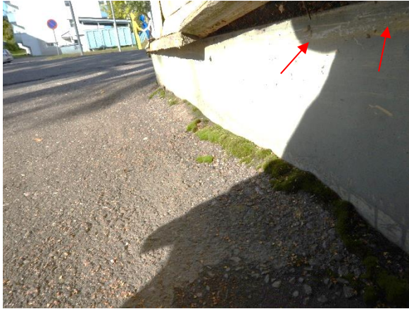
Kuva 9. Rakennuksen eteläpäädyssä asfalttipinnoite rajoittuu sokkeliin. Asfalttipinnoitteen päällä on sammalkasvustoa. Sokkelin pinnassa on jälkiä pitkäkestoisesta kosteusrasituksesta.
