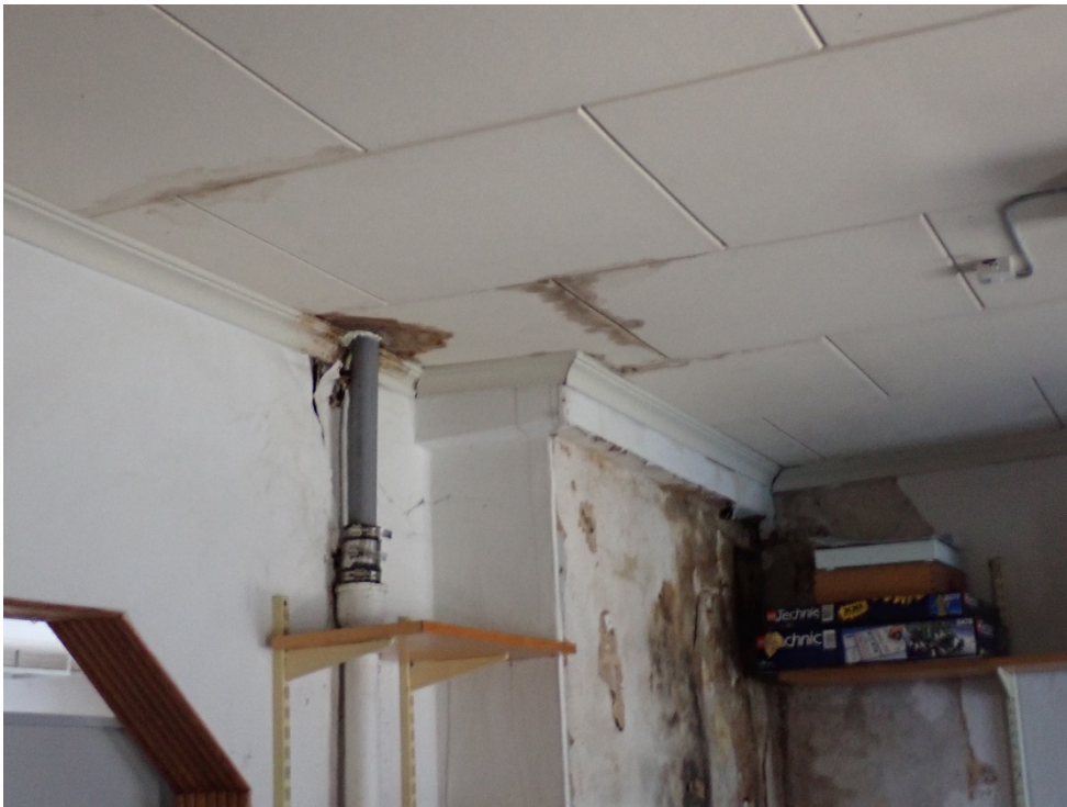
Vesikattovuotojen aiheuttamia vaurioita näkyvissä keskikerroksen katossa ja väliseinissä.
