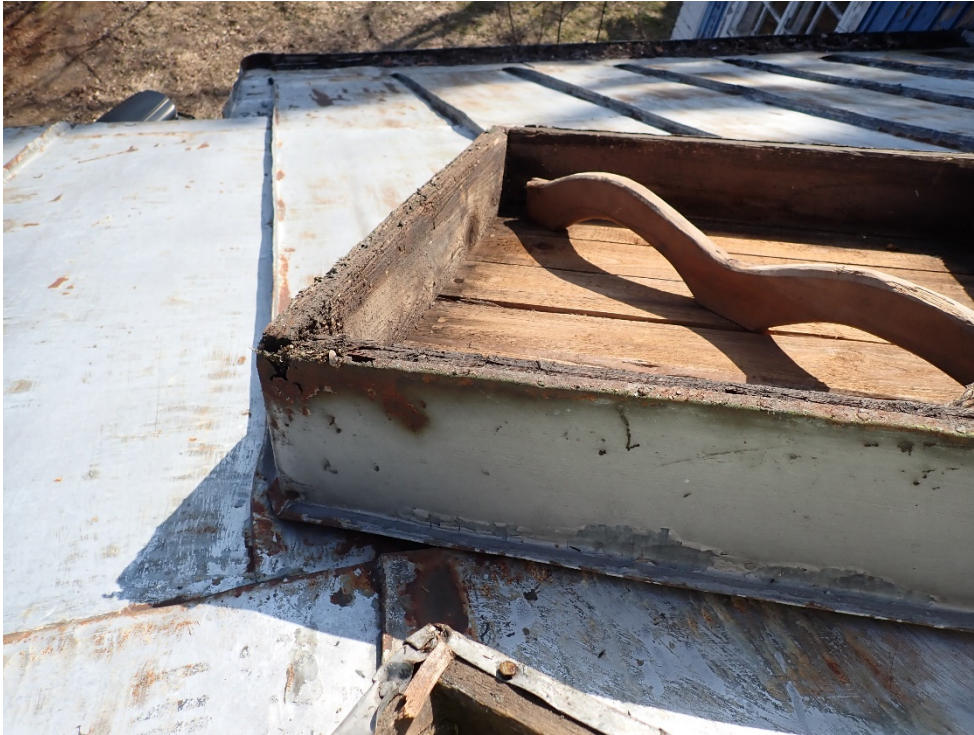
Kattopelleissä on ruostetta. Kattoluukun reunalaudat ovat lahonneet.
