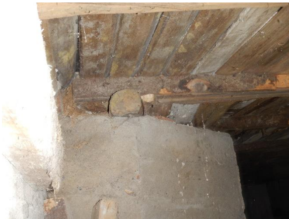
Kuva 22. Rossilaidoituksessa on silminnähtävää mikrobikasvustoa. Kuvassa näkyy tulisijan perustukset.
