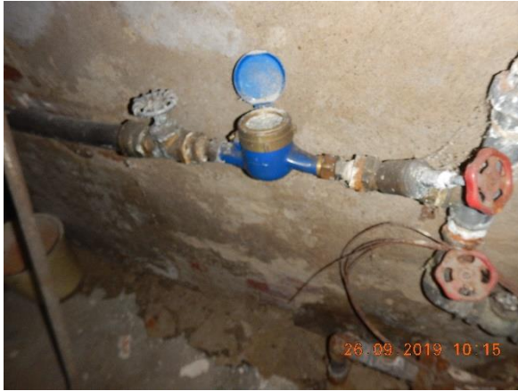
Kuva 99. Tonttivesijohto ja vesimittari
