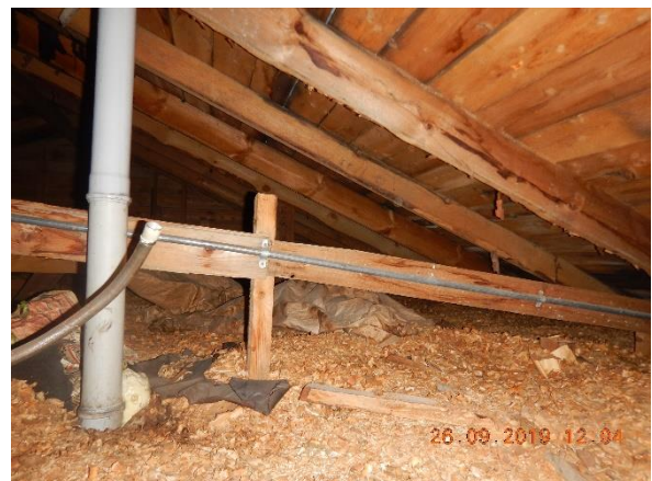
Kuva 23. Vuotojälkiä viemärin tuuletusputken läpiviennin kohdalla.
