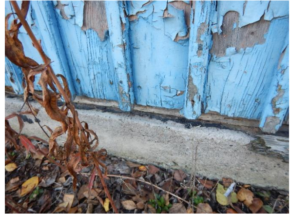
Kuva 46. Julkisivulaudoituksen alaosissa on havaittavissa lahoa. Helmalista on lahonnut ja pudonnut.
