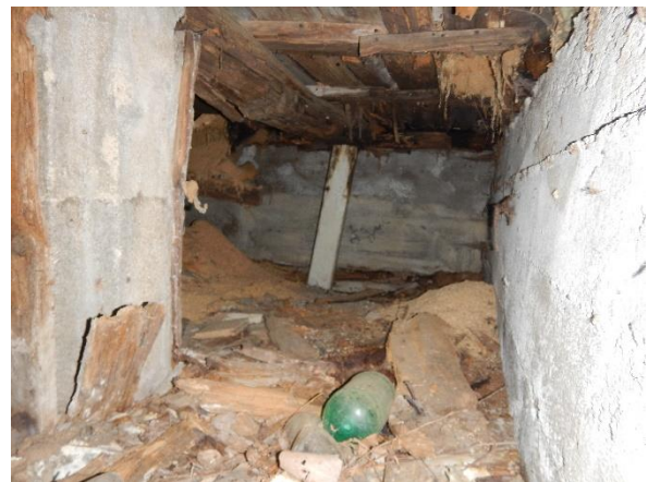
Kuva 14. Alapohjan puurakenteet ovat romahtaneet lahovaurion seurauksena. Kuva rakennuksen pohjoispäädystä.
