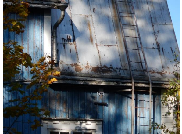
Kuva 63. Vesikatteen pinnassa on runsaasti ruostetta.
