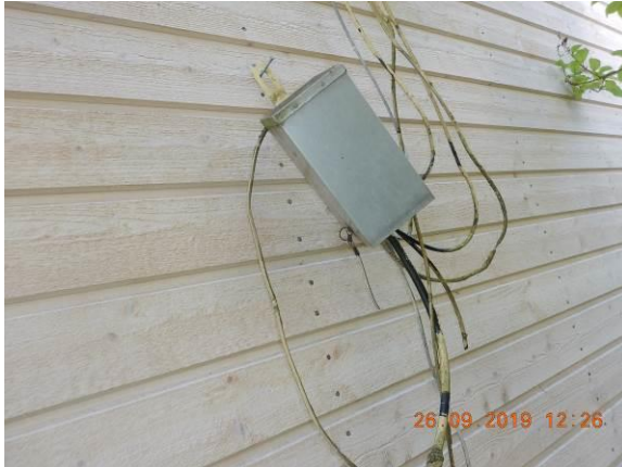
Kuva 100. Kytkentärasia kiinnittämättä ulkoseinään.
