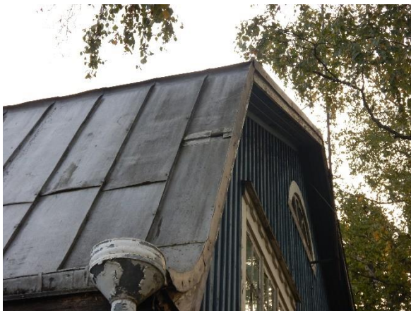
Kuva 66. Palapeltikatteen sauman limitys on auennut.
