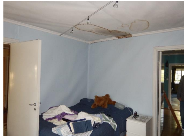
Kuva 76. Toisen kerroksen asuinhuoneen katossa on vesivuotojälki.
