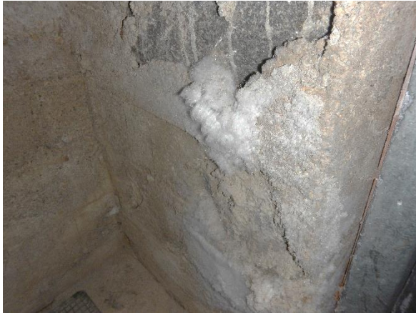
Kuva 26. Suolakertymää kellarin kantavissa betonirakenteissa.
