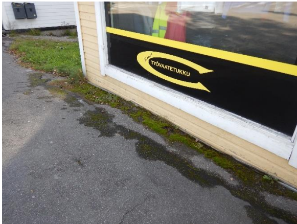
Kuva 11. Sokkeli on kokonaisuudessaan jäänyt maanpinnan ja päällysteiden alle rakennuksen länsipuolella.
