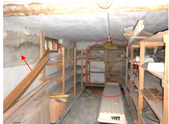
Kuva 19. Kellarikerroksen perusmuureissa on jälkiä voimakkaasta ja pitkäkestoisesta kosteusrasituksesta.
