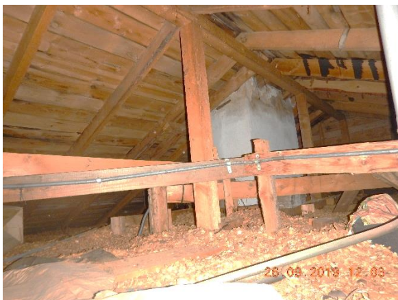
Kuva 22. Vuotojälkiä piipun läpiviennin kohdalla pihussa ja katon puurakenteissa.
