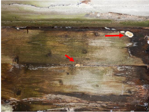
Kuva 32. Porrastasanteen alla ulkoseinärakenteen alaosassa on havaittavissa aktiivista lahottajasienikasvustoa.
