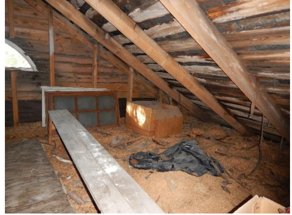
Kuva 33. Vesikaton puurakenteissa on kosteusjälkiä.
