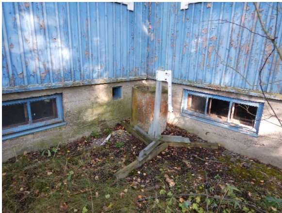
Kuva 14. Rakennuksen itäpuolen sokkeleissa esiintyvä halkeilu ja jälkiä pitkäkestoisesta kosteusrasituksesta.
