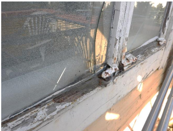
Kuva 46. Parvekkeen ikkunan alapuitteessa on pitkälle edennyttä lahoa. Ikkunalasi on särkynyt.
