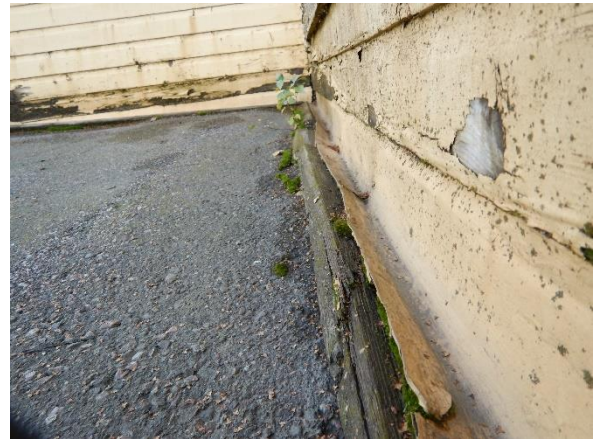
Kuva 35. Julkisivun alaosa on lahivaurioitunut kauttaaltaan rakennuksen länsipuolella.
