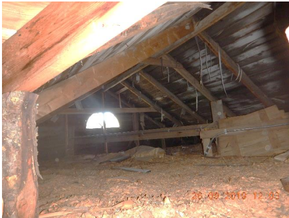
Kuva 20. Yleiskuva, yläpohja. Vesikaton puurakenteissa on vuotojälkiä.
