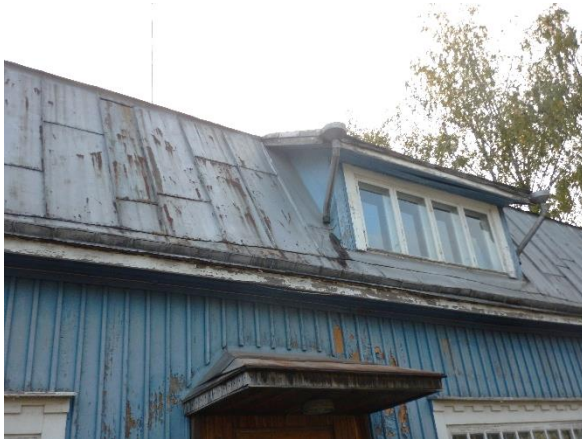
Kuva 11. Kattolyhdyn päältä tulevat vedet ohjataan syöksytorvilla kohti jalkarännejä. Kattolyhdyn sivuissa ei ole pellityksiä, jolloin syöksytorvista valuvat vedet kastelevat kattolyhdyn puurakenteita.
