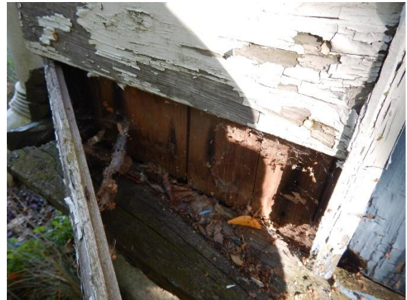
Kuva 48. Julkisivulaudoituksessa ja seinän kantavissa rakenteissa on pitkälle edennyttä lahoa.
