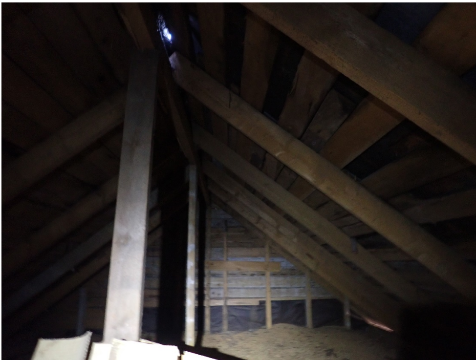
Kattorakenteita. Harjalla oli useita vuotoja. Tässä yksi näkyy hyvin.
