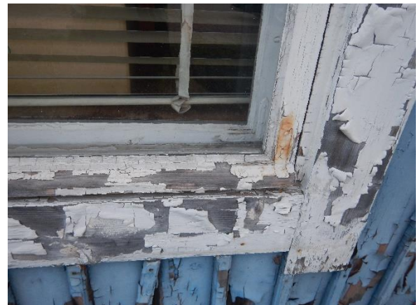
Kuva 53. Ikkunoiden maalipinta lehteilee merkittävästi. Puitteissa on paikoin havaittavissa lahovaurioita.
