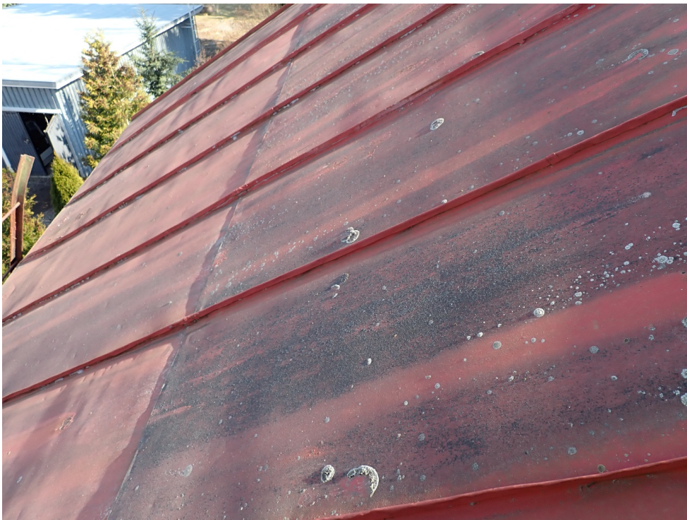
Peltikatossa jäkälää ja ruostelaikkuja.
