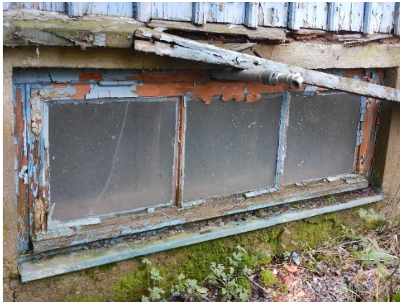
Kuva 56. Kellarin ikkunapuitteissa on lahovaurioita ja kitit ovat paikoin irronneet.
