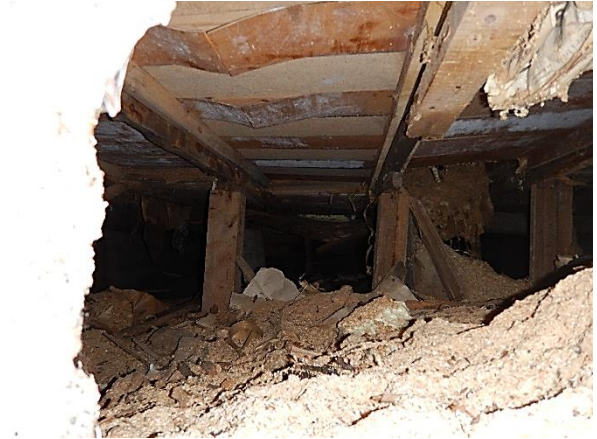
Kuva 16. Lahovaurioitunut rossilaudoituus on korjattu, mutta uudessa levytyksessä on havaittavissa mikrobivaurioita. Lattian eristetäyttö on jätetty ryömintätilaan. Kosteaa eristetäyttöä toimii mikrobien ja lahottajasienten kasvualustana.
