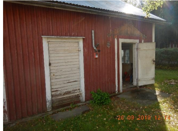
Kuva 6. Piharakennuksessa on lämmönjakohuone, joka sijaitsee kuvassa oikealla.
