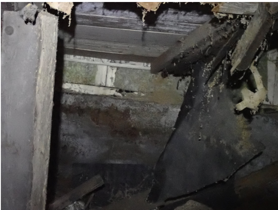
Romahtanutta alapohjaa. Kuvan keskellä näkyy sokkeli, jossa näyttäisi olevan mahdollisesti lattiasienikasvustoa. Seinää on korjattu muutama vuosi sitten. Tämä korjattu seinäosuus on pohjoispäädyssä koillisnurkan vieressä. Seinässä on mineraalivillaeristys.
