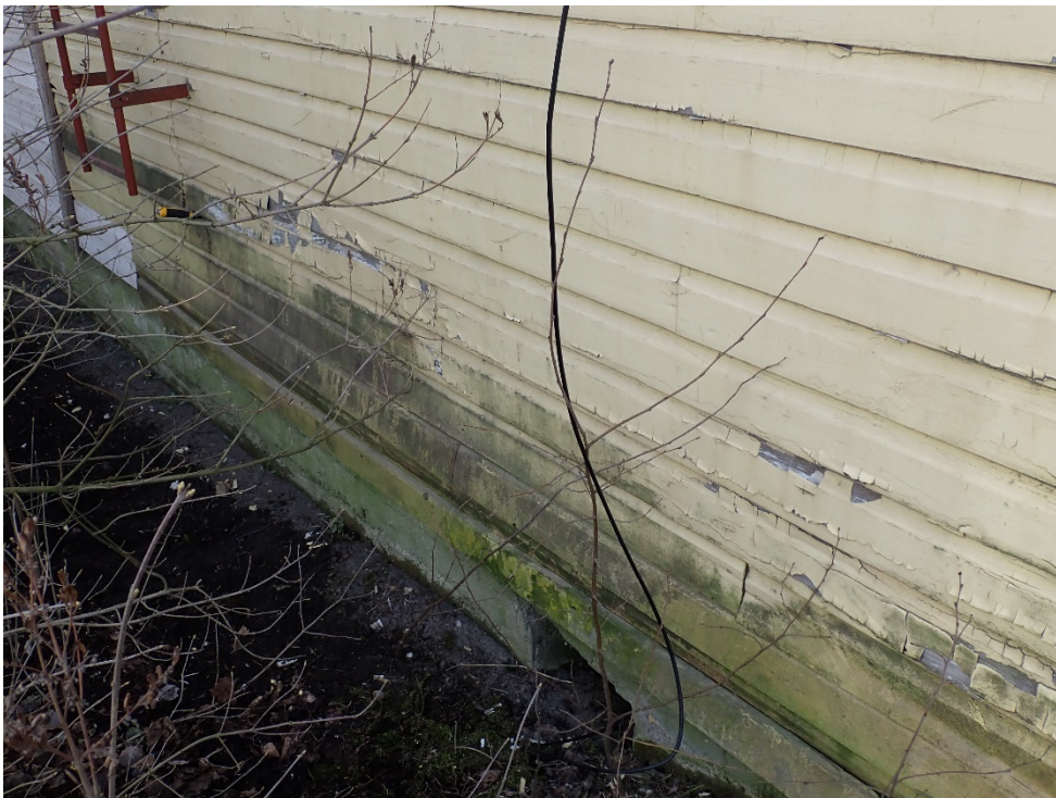
Pohjoisseinää. Seinälaudoitus on pullahtanut ulospäin kun runko on lahonnut alapäästä pois.
