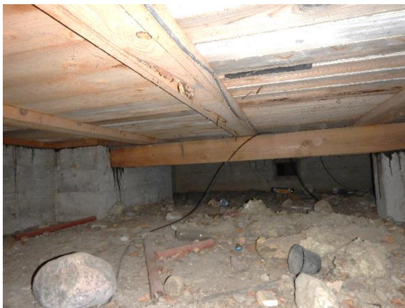
Kuva 13. Ryömintätilassa on roskaa. Kuva rakennuksen lounaiskulman alueelta.
