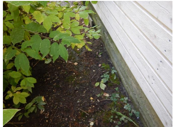
Kuva 12. Rakennuksen pohjoispuolella sokkelissa on havaittavissa sammalkasvustoa.
