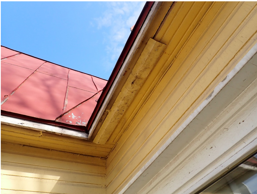
Ilmeisesti jotain vauriota ollut räystään alla, kun on peitetty laudalla.
