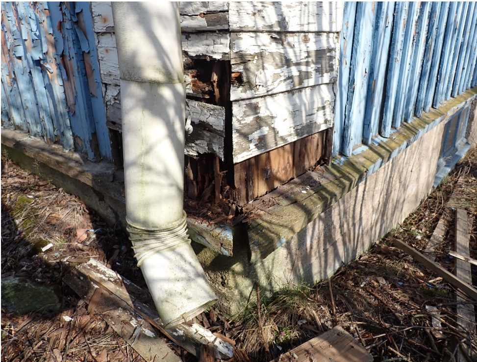
Lounaisnurkalla on lahovaurioita räystäällä ja nurkassa oikeastaan koko korkeudella.
