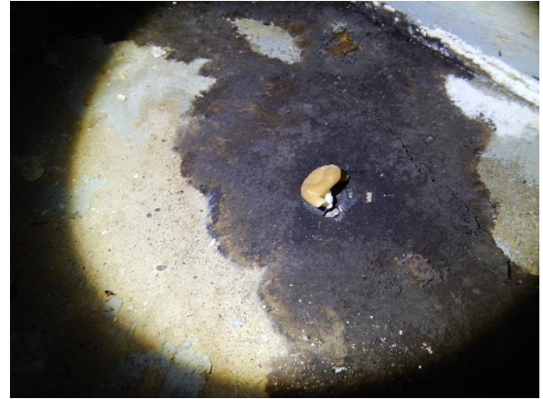
Kuva 25. Sienikasvustoa kellarin lattialla.
