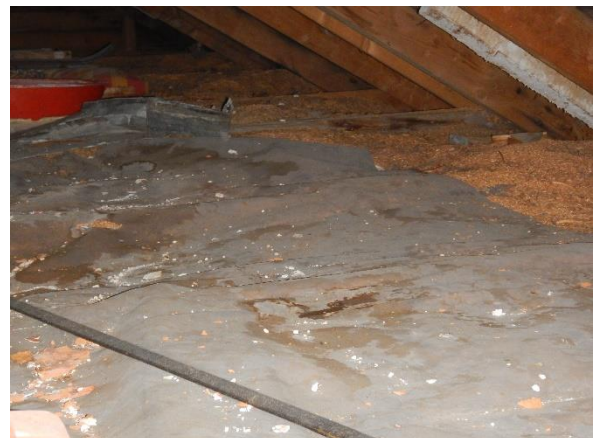
Kuva 37. Eristeiden päälle levitetyn peitteen päällä on vuotojälkiä. Asuintiloista yläpohjatilaan tuleva kosteus
