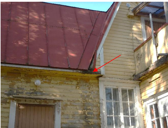
Kuva 30. Vesikatolta valuva vesi kastelee julkisivua. Rästyslaudoitus on lahovaurioitunut.
