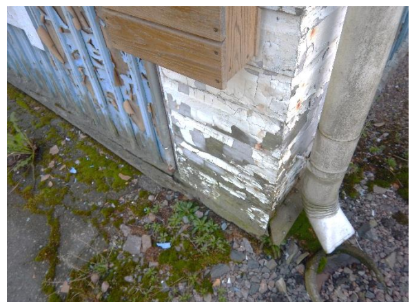
Kuva 50. Seinän alaosa on monin paikoin joko maanpinnan tasalla tai sen alapuolella. Seinä alaosan
