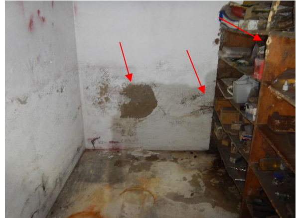
Kuva 27. Kellarin varastuhuoneessa havaittiin aktiivinen lahottajasienikasvusto. Seinissä sekä puisessa hyllyssä on havaittavissa sienien itiömiä, jotka ovat itiöityneet.
