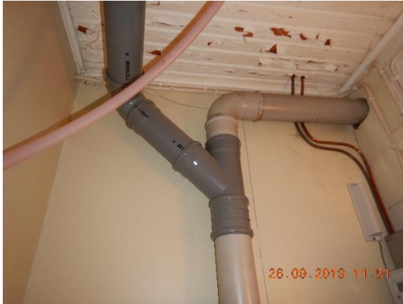
Kuva 79. Eri aikakausilla uusittuja muoviviemäreitä
