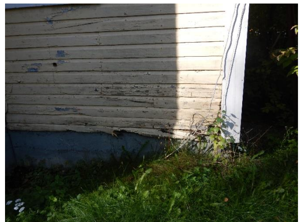
Kuva 29. Julkisivulaudoituksen alaosa on lahovaurioitunut rakennuksen itäpuolella.
