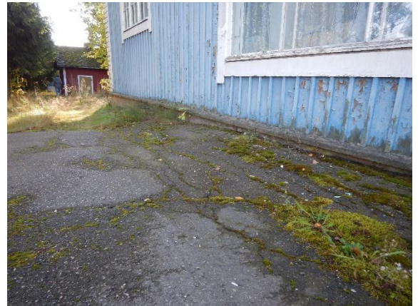
Kuva 3. Rakennuksen pohjoispuolella on pääosin asfalttipäälluste. Rakennuksen sokkeli on jäänyt maanpinnan alle. Asfaltti on halkeillut monin paikoin.
