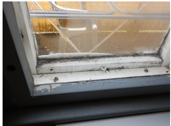
Kuva 45. Parvekkeen ikkunan ulkupuitteen sisäpinnalla on kosteusjälkiä.
