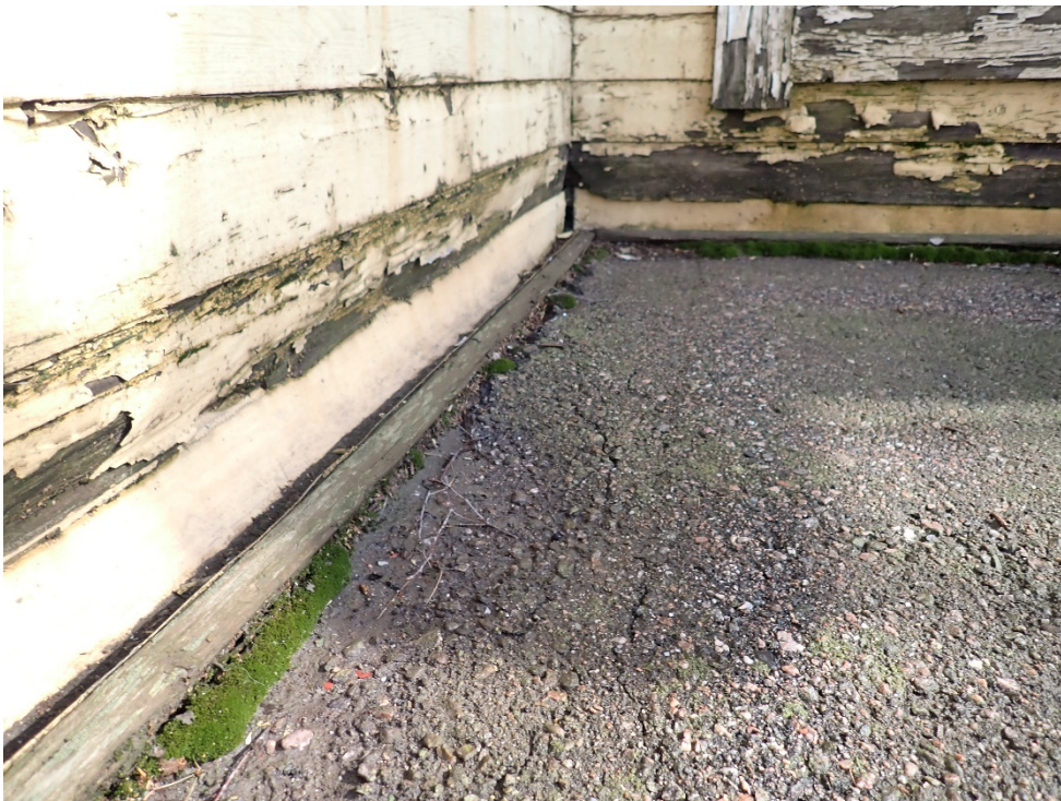
Kadun puoleista seinää. Seinän alosaan laitettu pelti on kääntynyt vesikouruksi seinän vajottua alemmas. Kouru johtaa sadevedet seinänurkasta sisään.
